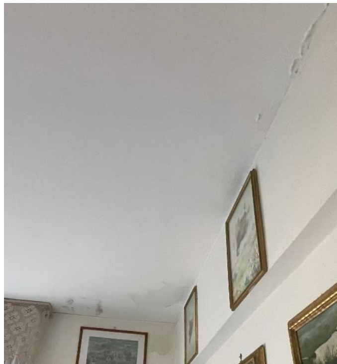
Foto 22. Particolare infiltrazioni e scrostamento pittura soffitto soggiorno
