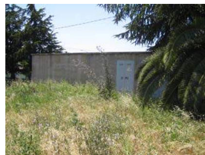
Foto 57 , Vista cabina Enel
