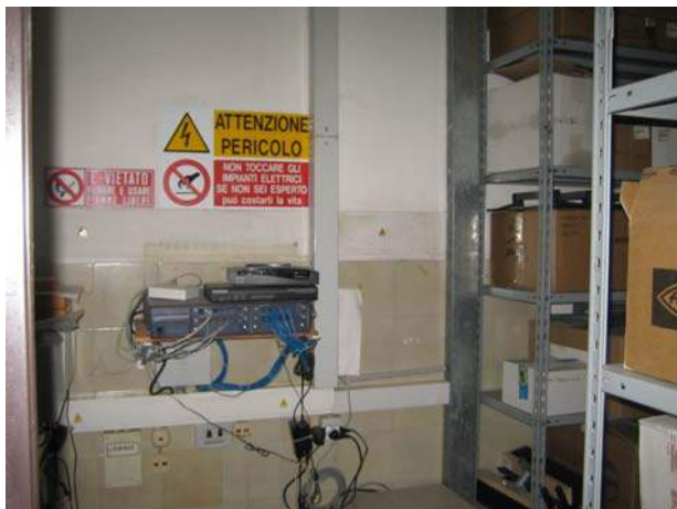
Foto 21, Locale tecnico PT
