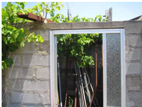
Foto 13 , Baraccamenti esterni in condizioni fatiscenti
