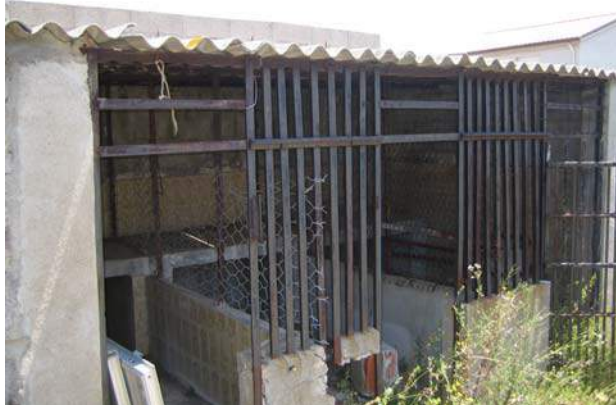
Foto 14 , Baraccamenti esterni in condizioni fatiscenti
