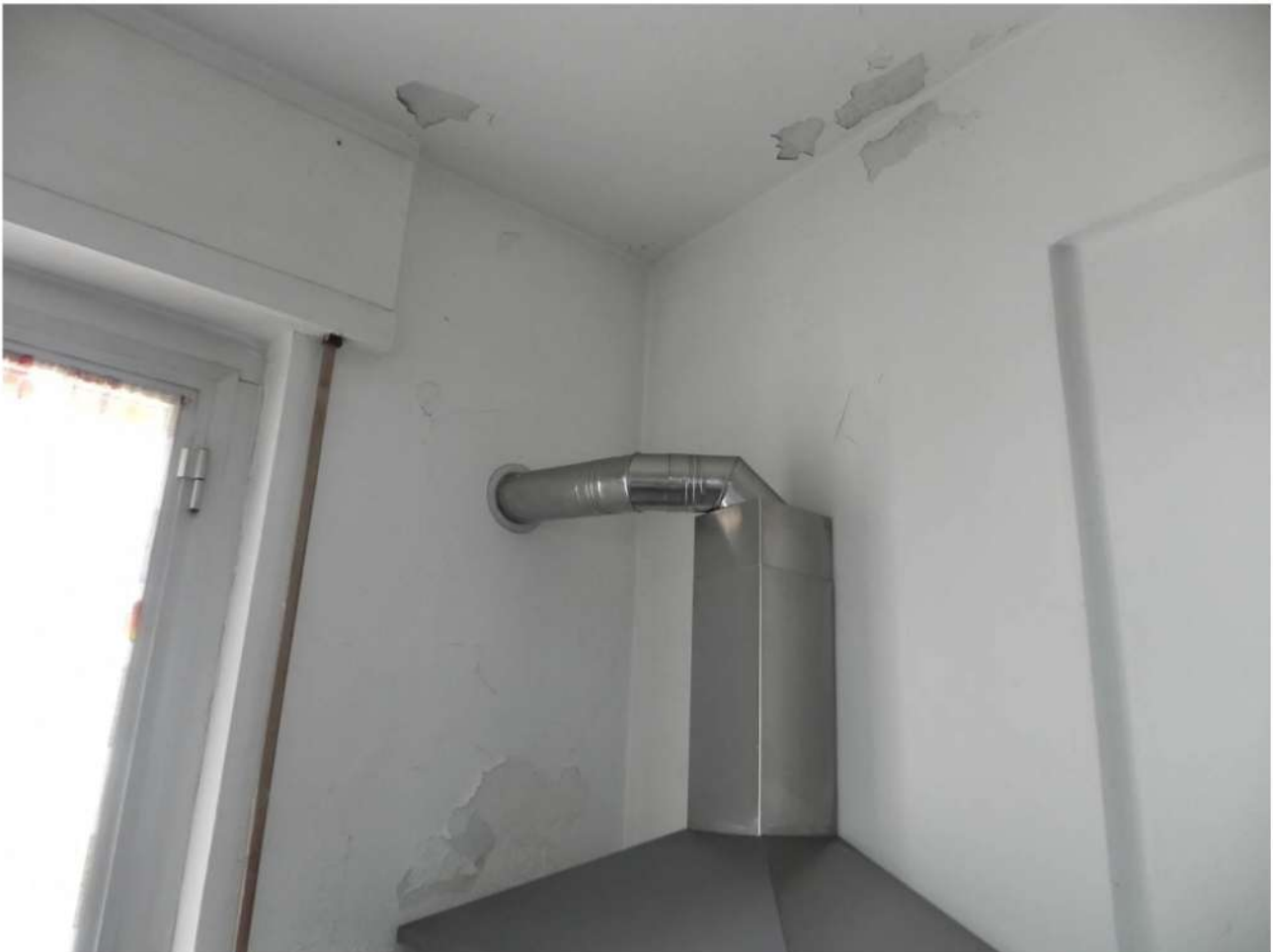
Foto 36– Dettaglio delle infiltrazioni della Cucina
