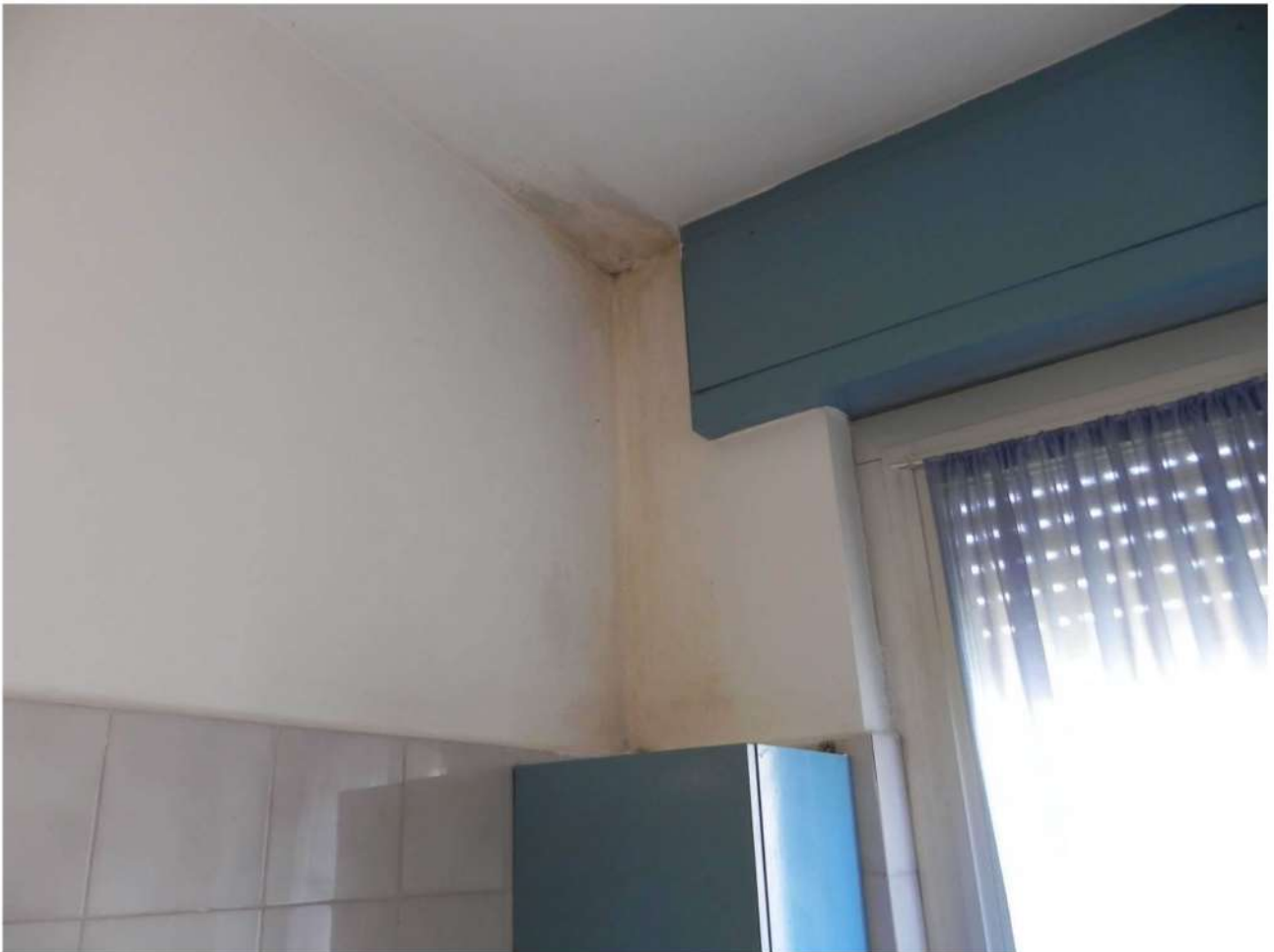
Foto 39– Dettaglio delle infiltrazioni del Bagno
