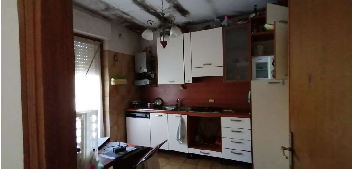
Foto 6 Cucina (si notano segni di umidità al soffitto)
