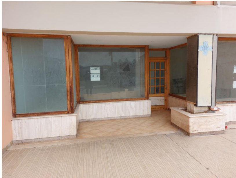
Foto n.103: Altro particolare del fabbricato residenziale (BENE N). Notare il portoncino dell'ingresso e gli infissi in legno e vetro.
