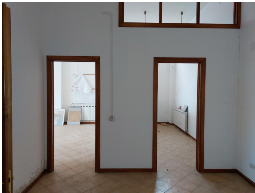
Foto n.106: Particolare del deposito (BENE N). Nella foto sono visibili gli elementi radianti dell'impianto di riscaldamento in alluminio.
