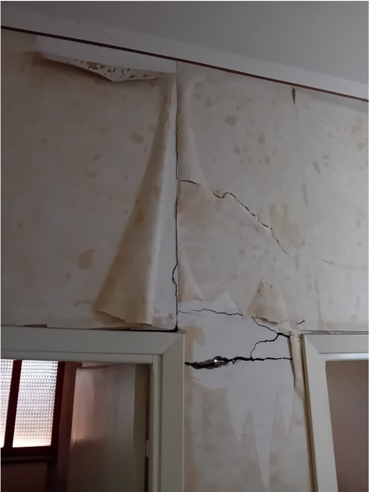
Cedimento tramezzature per collasso solaio tra piano terra e primo
