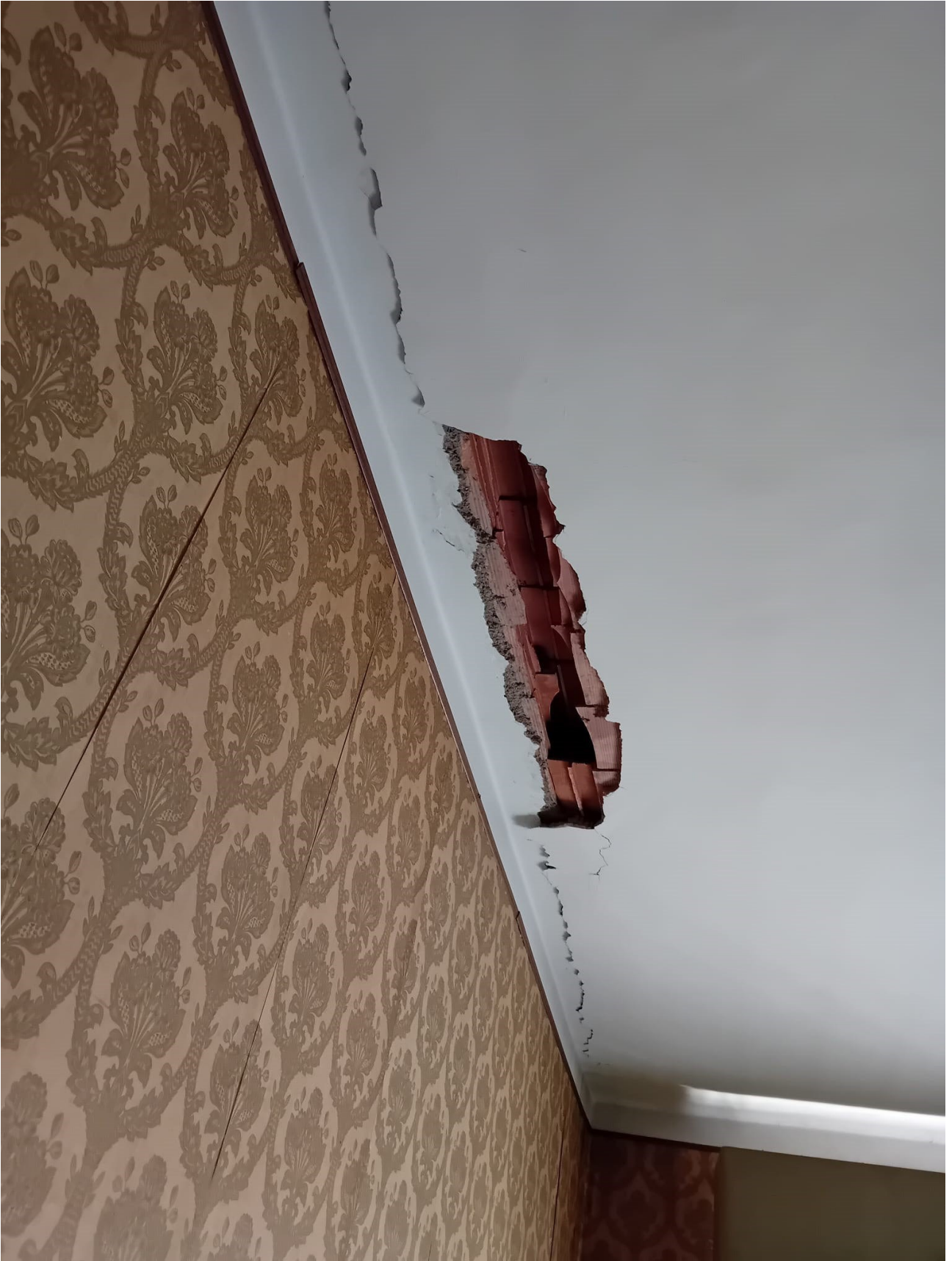
Cedimento solaio/soffitto sala
