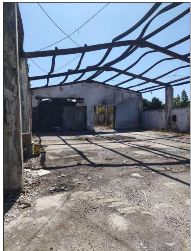
Copertura Corpo B. Deformazioni delle travi in ferro.
