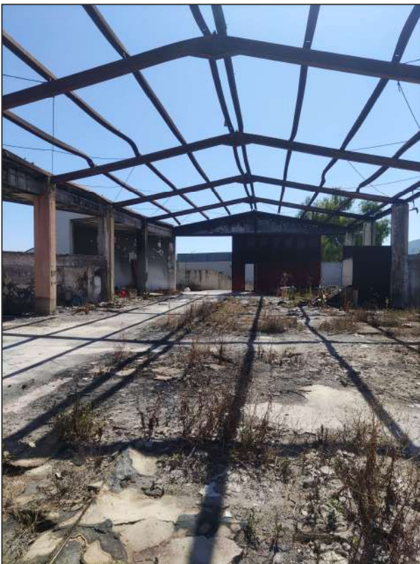
Copertura Corpo A. Deformazioni delle travi in ferro.
