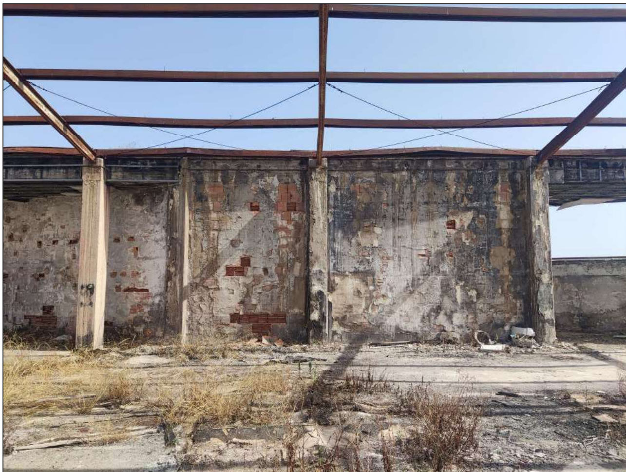
Stato di ammaloramento dei muri di topagnamento esterni
