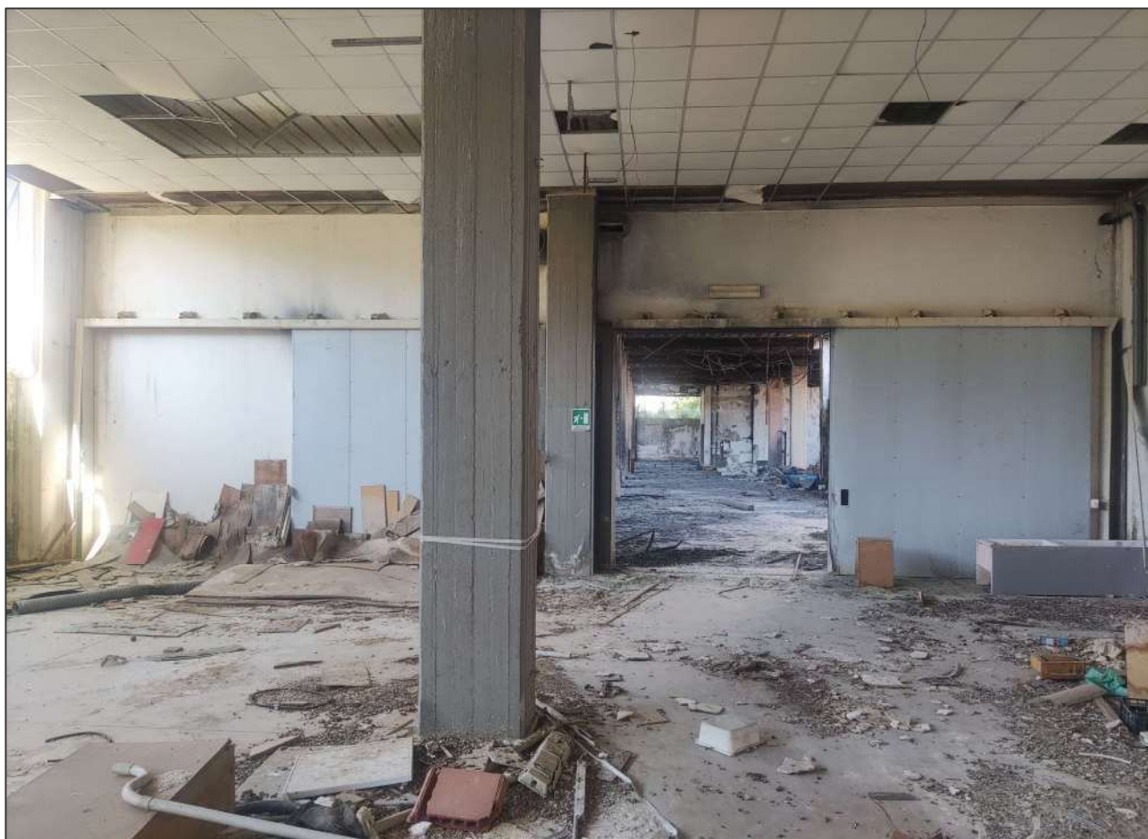
Setto murario di divisione fra i due corpi di fabbrica non coincidente con gli effettivi limiti di proprietà
