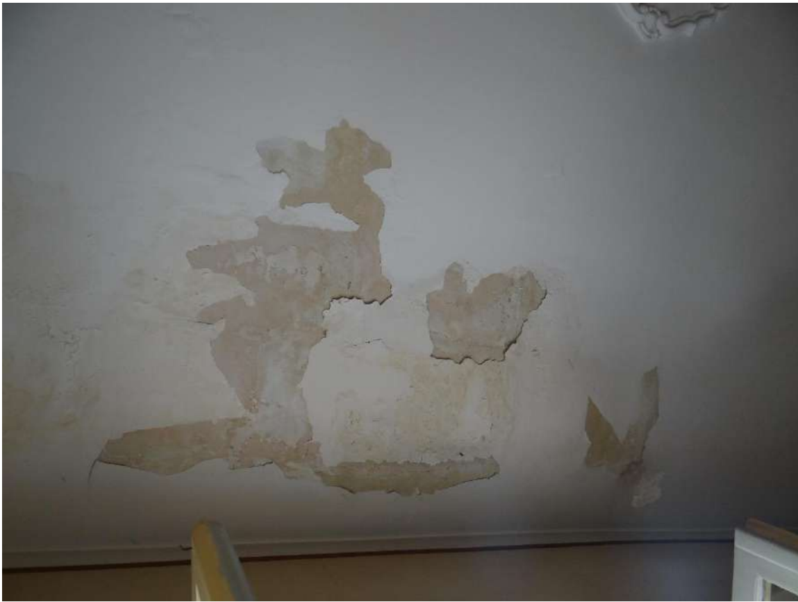
Fotografia 12: danni da infiltrazione d'acqua sul soffitto della camera da letto.
