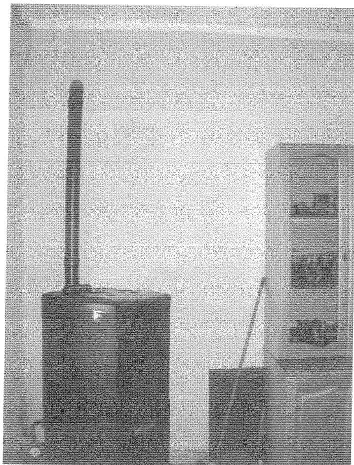
Foto 7: Impianto di riscaldamento
