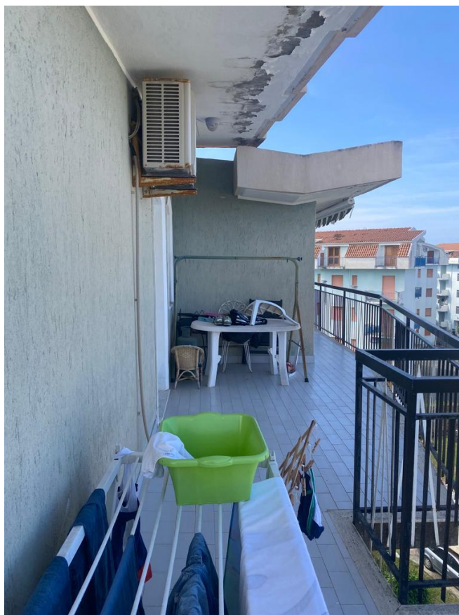
Foto 19: vista esterna sub. 12 – particolare balcone
