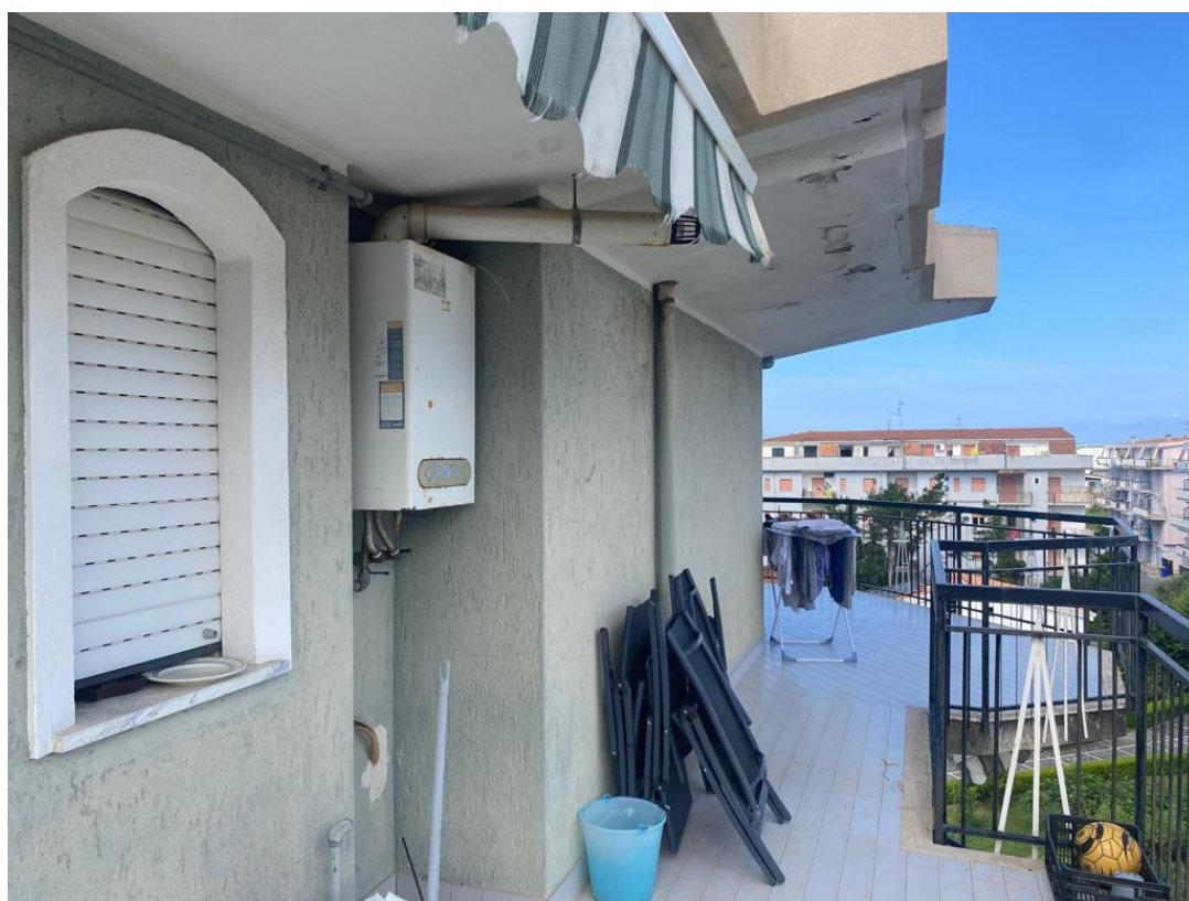
Foto 18: vista esterna sub 12 - particolare balcone
