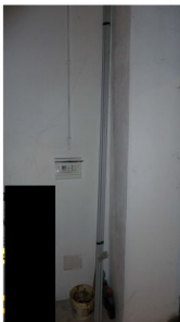
Foto 13 – Il salvavita dell'impianto elettrico
