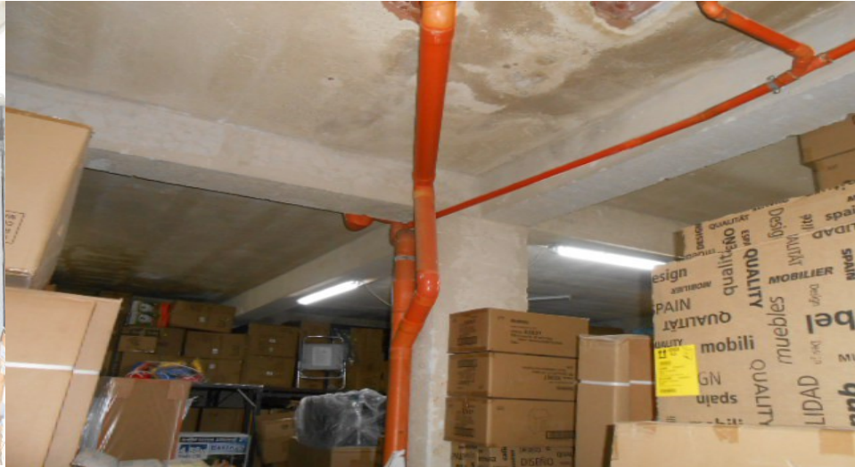
3. Interno del magazzino. Le macchie nel soffitto appaiono come segni di pregresse infiltrazioni riparate.
