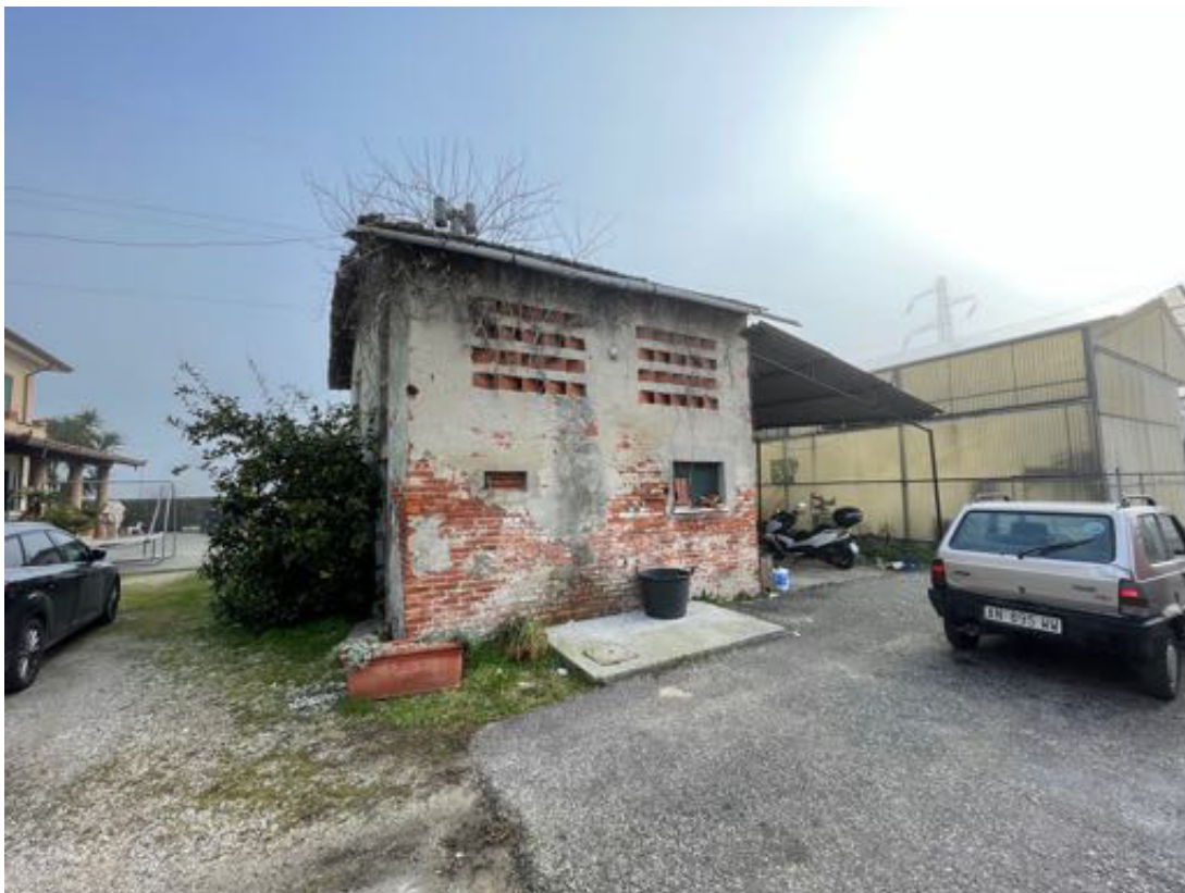
Lotto 3 – foto 24 – Manufatto pertinenziale semidiroccato con retrostante tettoia da regolarizzare e/o smantellare
