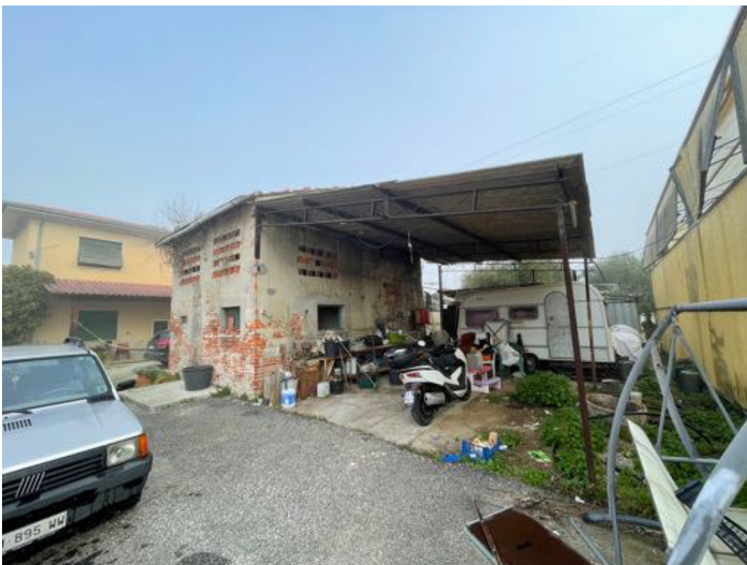
Lotto 3 – foto 25 – Manufatto pertinenziale semidiroccato con retrostante tettoia da regolarizzare e/o smantellare
