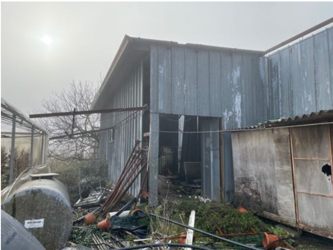
Lotto 3 – foto 27 – Manufatto in lamiera condonato
