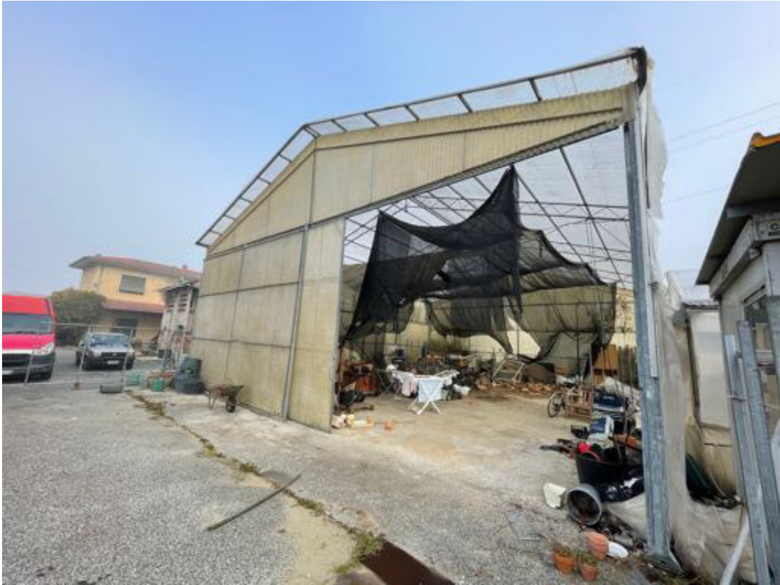
Lotto 3 – foto 26 – Manufatto con struttura metallica da regolarizzare e/o smantellare
