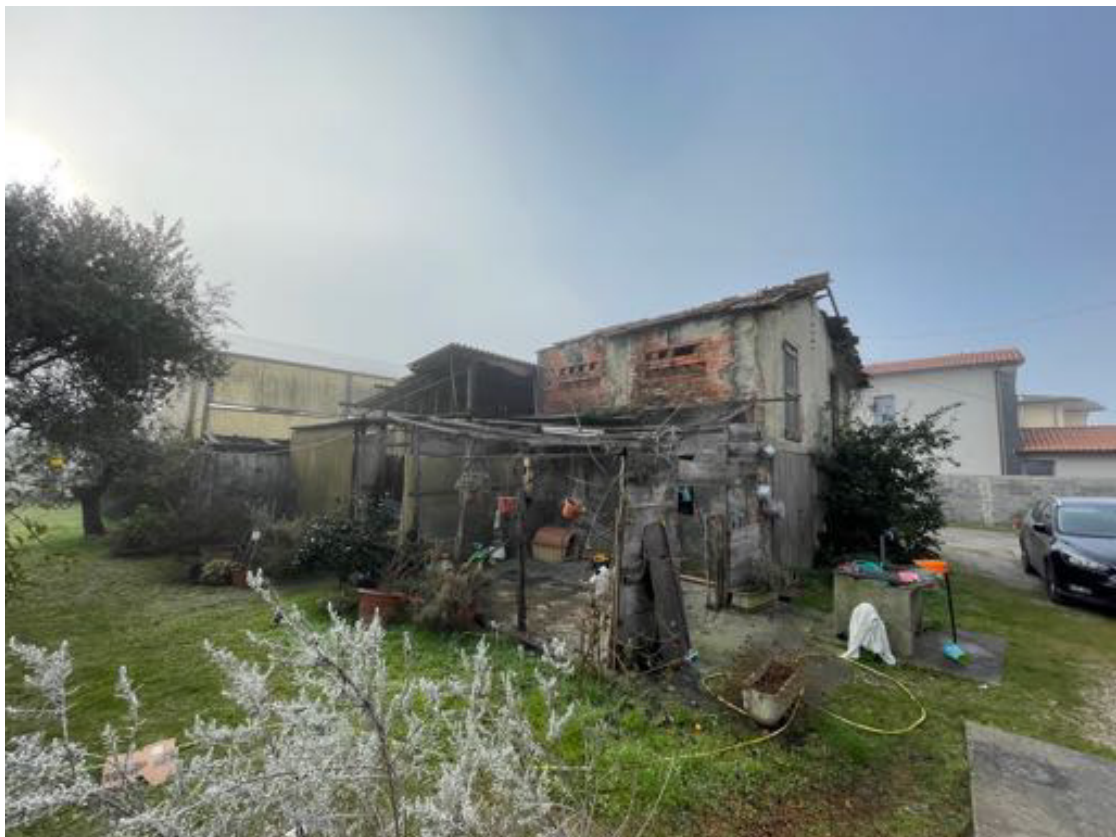
Lotto 3 – foto 23 – Manufatto pertinenziale semidiroccato con manufatti precari da demolire
