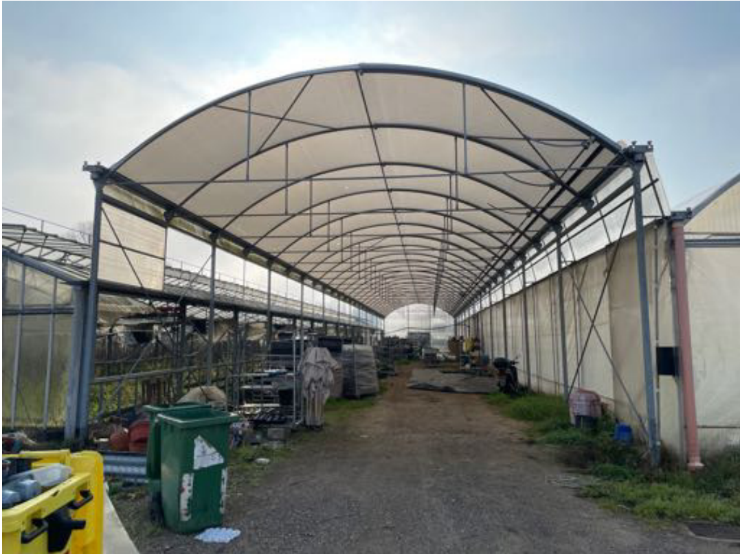
Lotto 1 – foto 4 – Collegamento tra serre fisse e mobili – Da regolarizzare e/o smantellare
