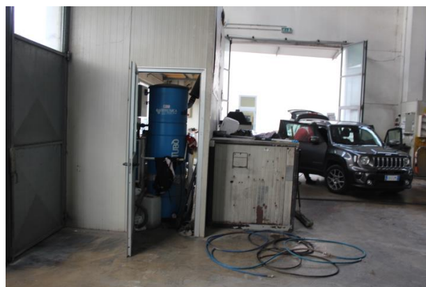
CAPANNONE -AUTOLAVAGGIO- VISTA DEL VANO COMPRESSORI
