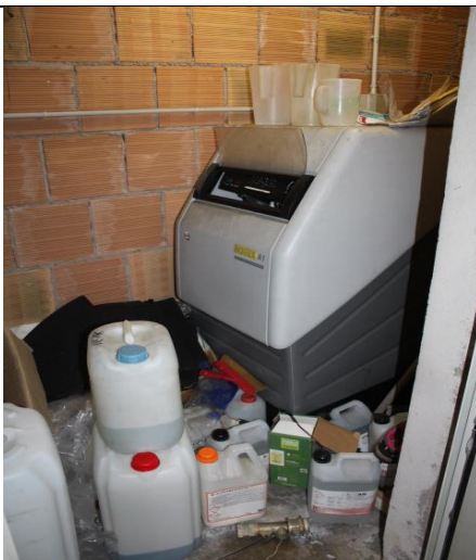
CENTRALE TERMICA NEL SOTTOSCALA (caldaia NON funzionante)
