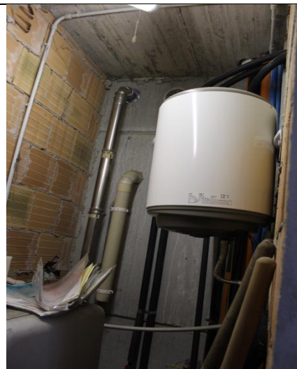
BOILER ELETTRICO PER PRODUZIONE ACQUA CALDA SANITARIA
