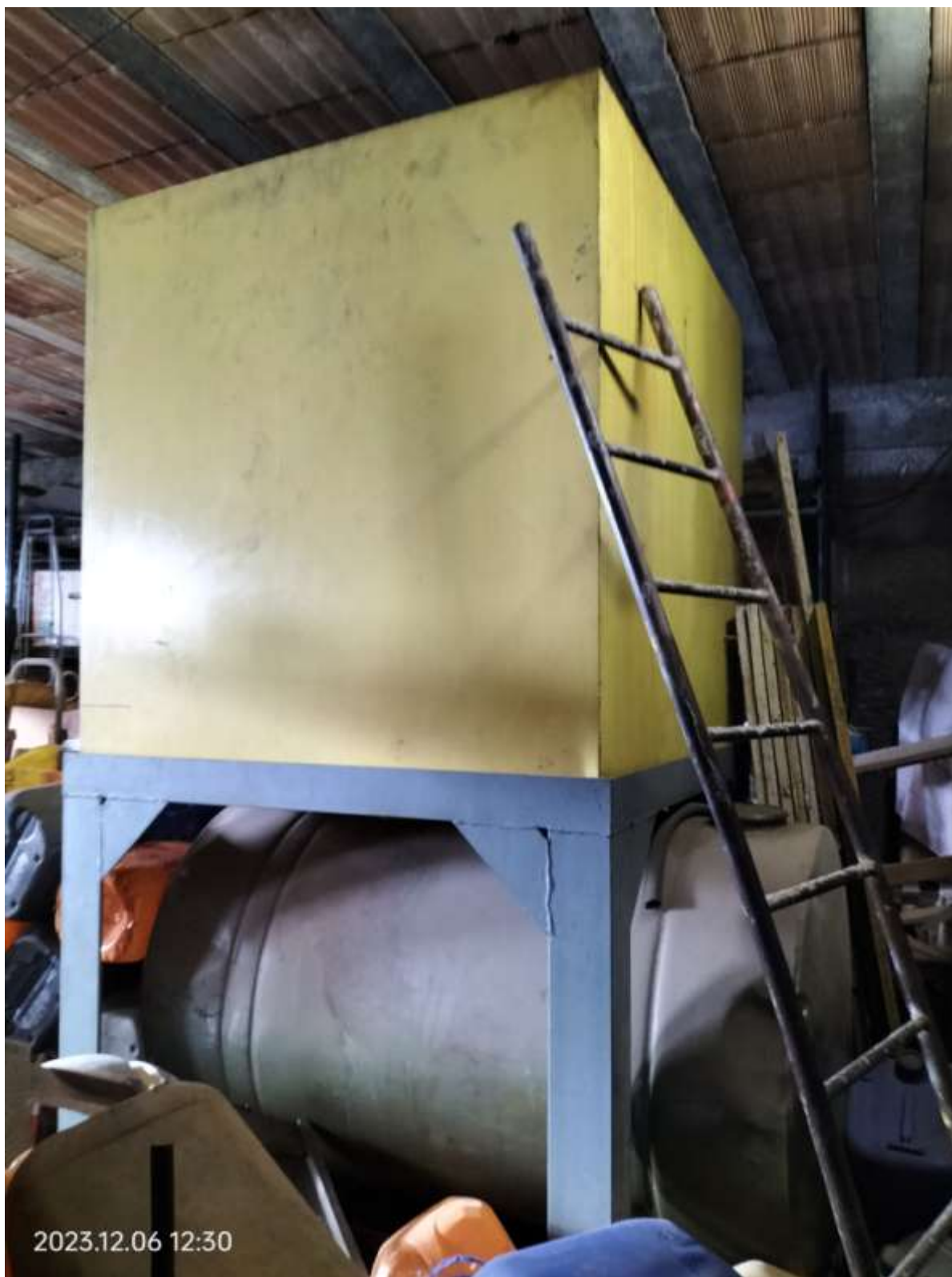
serbatoio del gasolio con struttura fuori terra (ubicato nel locale al piano seminterrato sub. 7 appartenente ad altra ditta)
