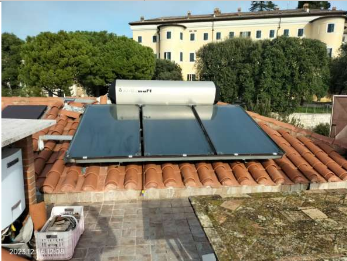
impianto solare termico in copertura (produzione acqua calda sanitaria)
