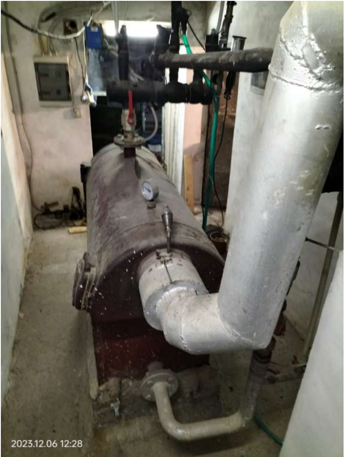
generatore di calore a gasolio (ubicato nel locale al piano seminterrato sub. 6 appartenente ad altra ditta)
