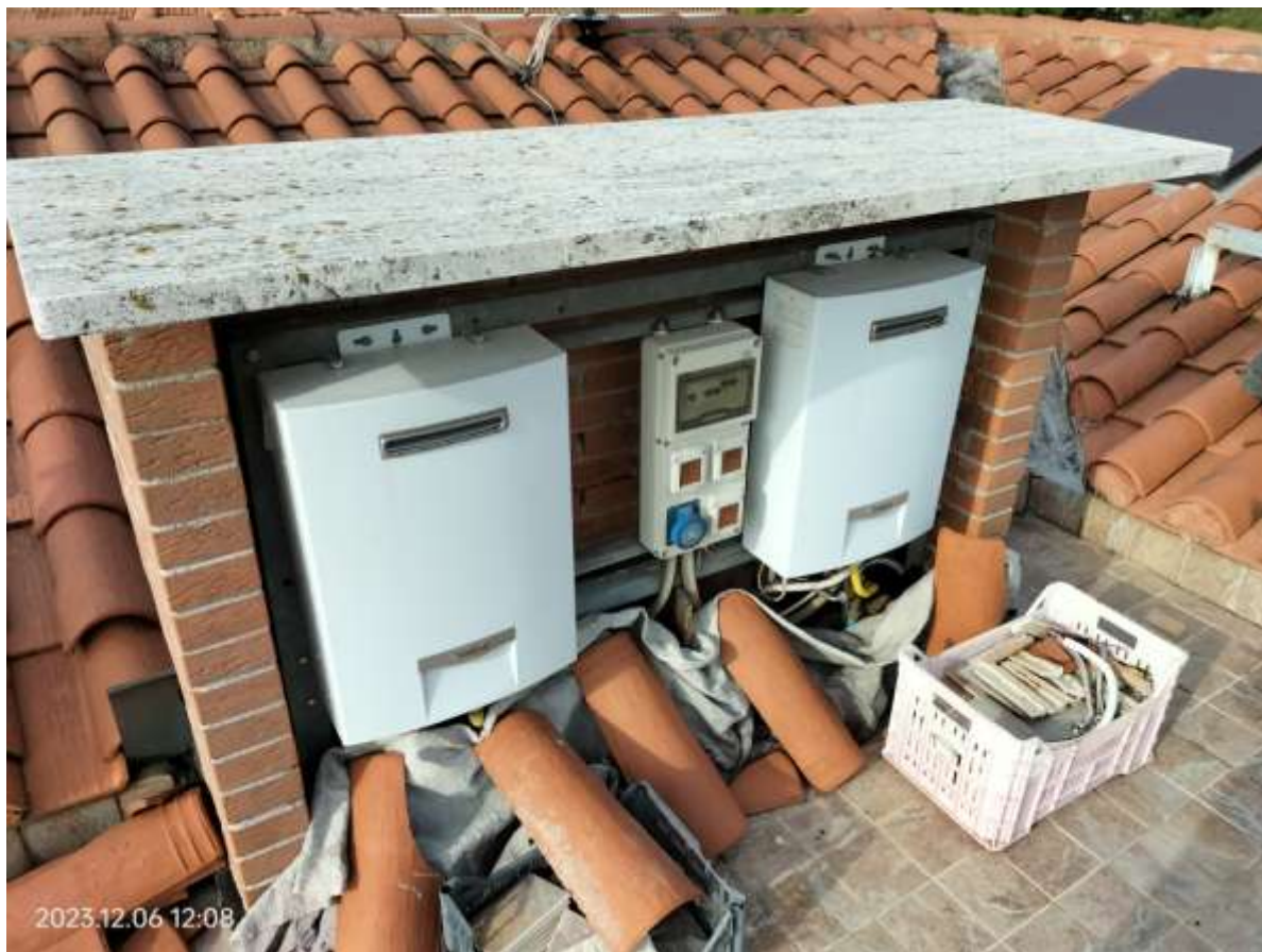
caldaie a metano nel terrazzo di copertura per a.c.s.
