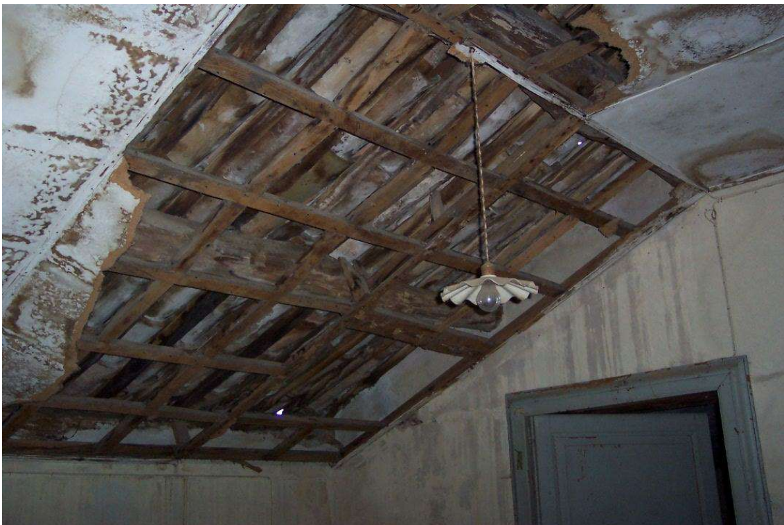
Foto 8 – Lotto 2: particolare dello stato di degrado della copertura e della controsoffittatura
