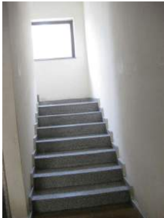
Fabbricato sito in via P. Borsellino n.263/A – Ingresso al fabbricato dal piano Terra – Vano scala
