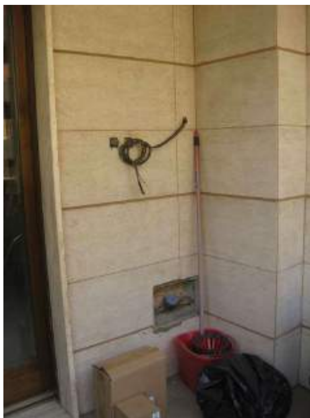
Fabbricato sito in via P. Borsellino n.263/A – Predisposizione caldaia a metano per immobile part. 1188 sub.49
