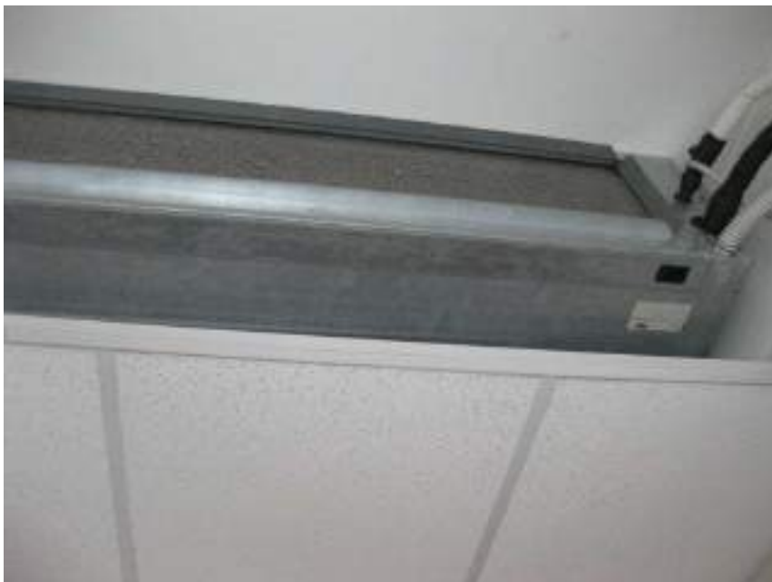
Fabbricato sito in via P. Borsellino n.263/A – Particolare unità interna A.C. immobile part. 1188 sub.49
