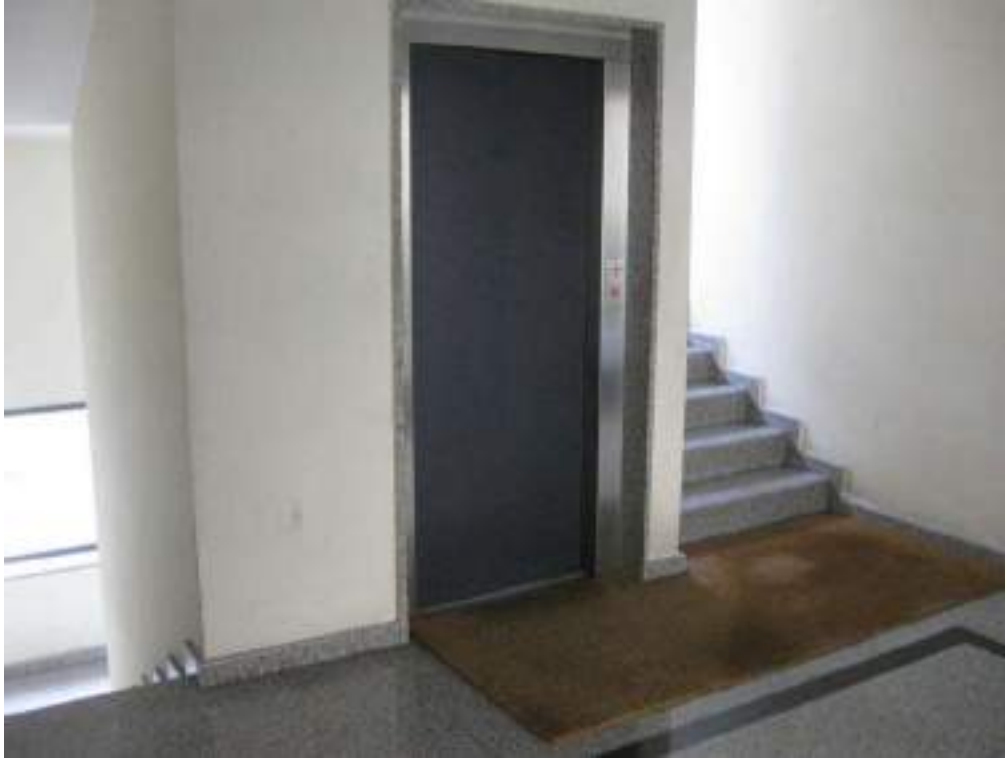
Fabbricato sito in via P. Borsellino n.263/A – Ingresso al fabbricato dal piano Terra - Ascensore
