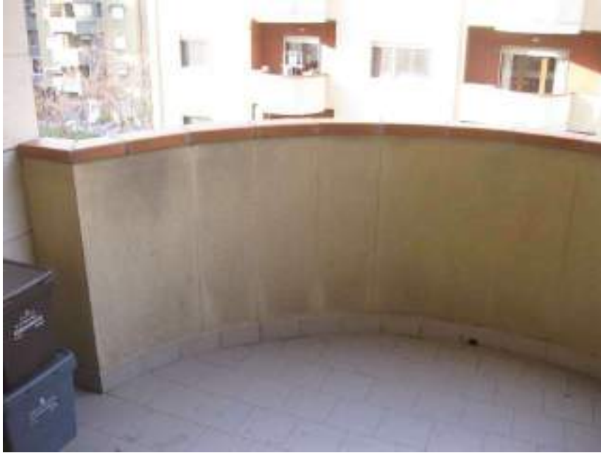
Fabbricato sito in via P. Borsellino n.263/A – Balcone immobile part. 1188 sub.49
