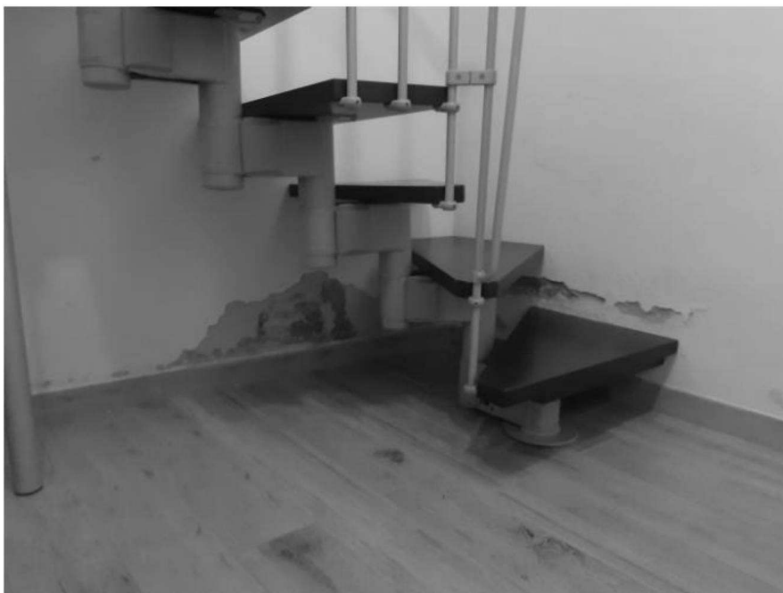
Foto 38. Camera da letto singola - Particolare di alcuni fenomeni di umidità di risalita capillare
