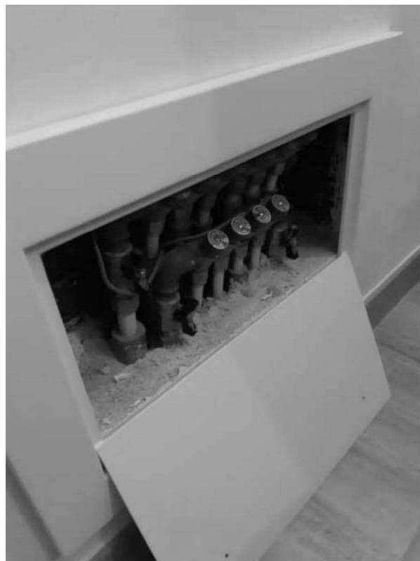
Foto 44. Particolare del collettore planare dell'impianto idrico
