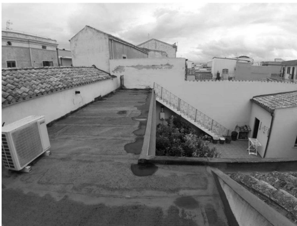
Foto 18. Terrazza primo piano. Particolare della scala in muratura che sarebbe dovuta essere rimossa
