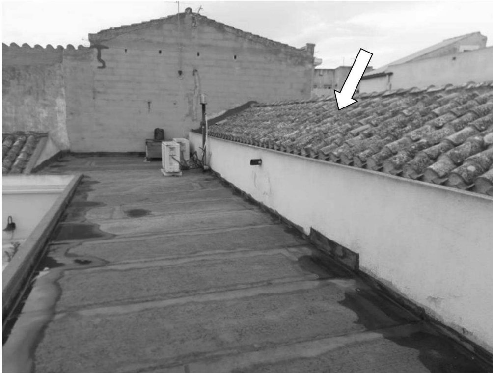
Foto 13. Terrazza primo piano. In evidenza la copertura oggetto dell'abuso
