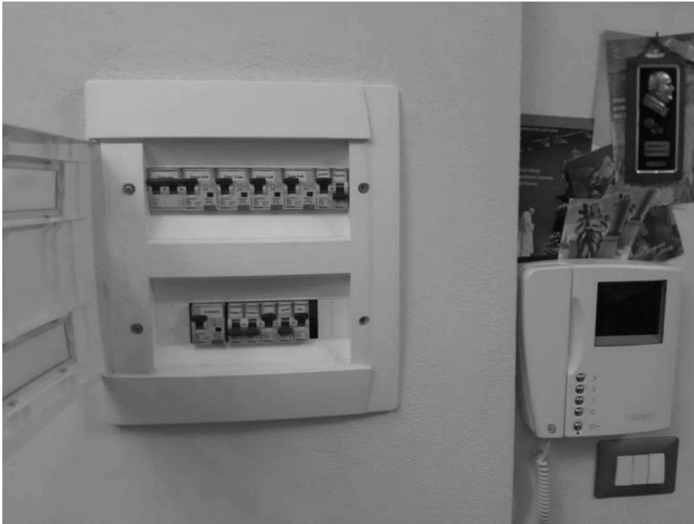
Foto 43. Particolare del quadro generale dell'impianto elettrico
