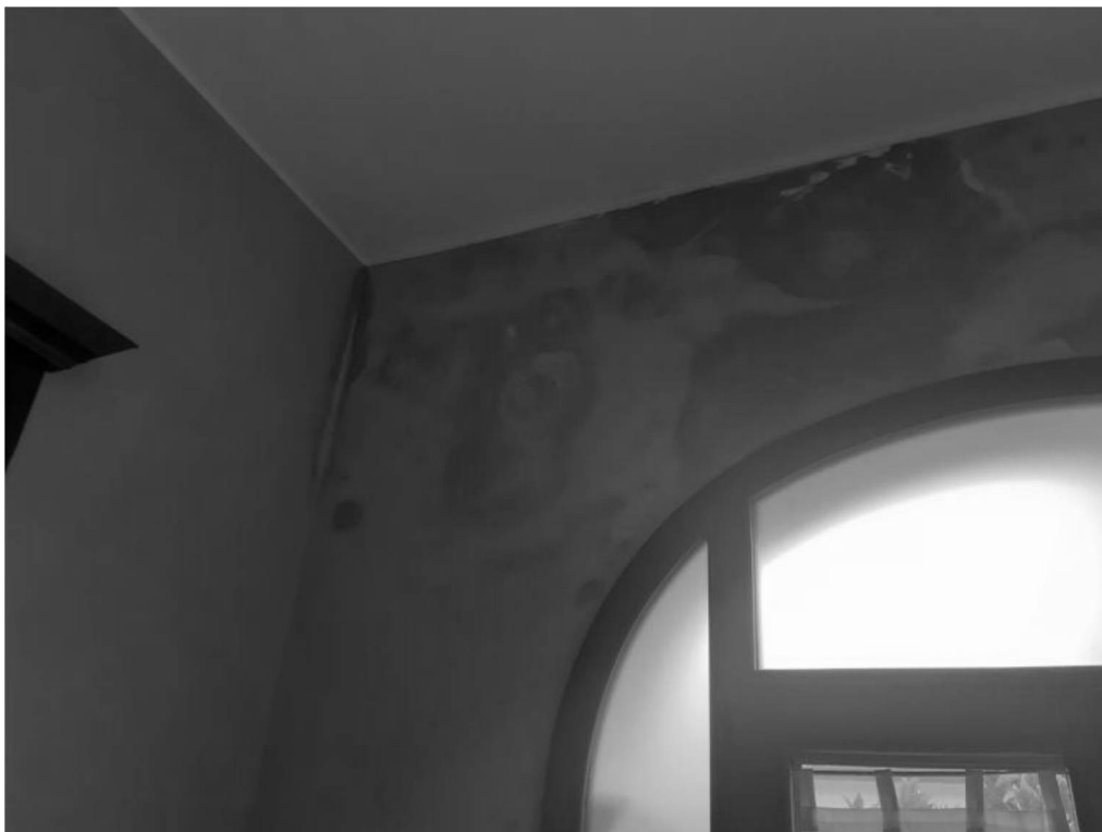
Foto 42. Infiltrazione proveniente dalla copertura piana del loggiato
