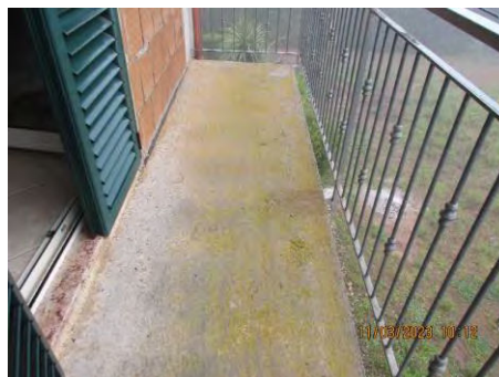
Foto n. 29 – Balcone non pavimentato
