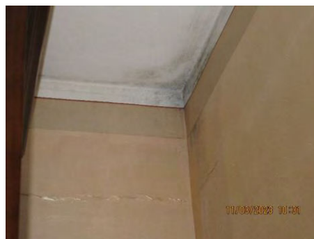
Foto n. 33 – Umidità presente camera da Letto n.3
