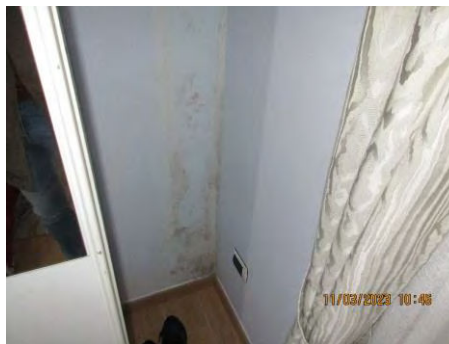
Foto n. 12 – Camera da letto- Presenza di umidità
