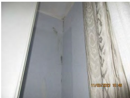
Foto n. 11 – Camera da letto- Presenza di umidità
