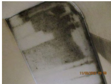
Foto n. 31 – Umidità presente nel vano scala
