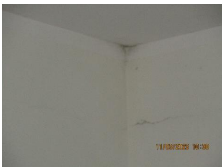
Foto n. 32 – Umidità presente camera da Letto n.1
