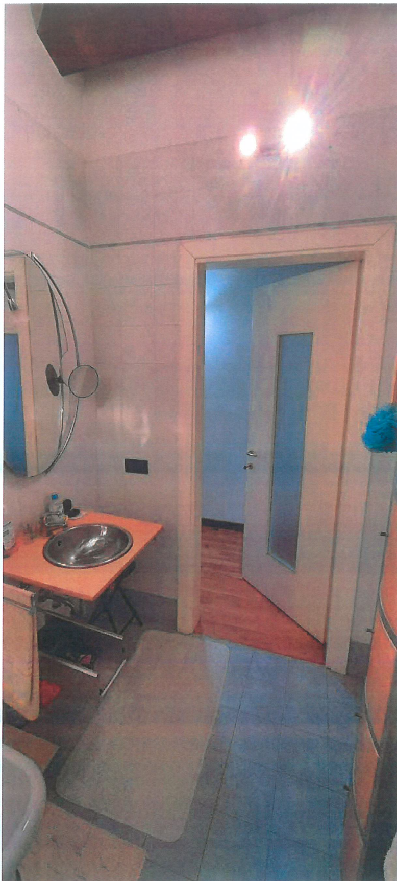
Sottotetto – 4 Bagno (abusivo)
