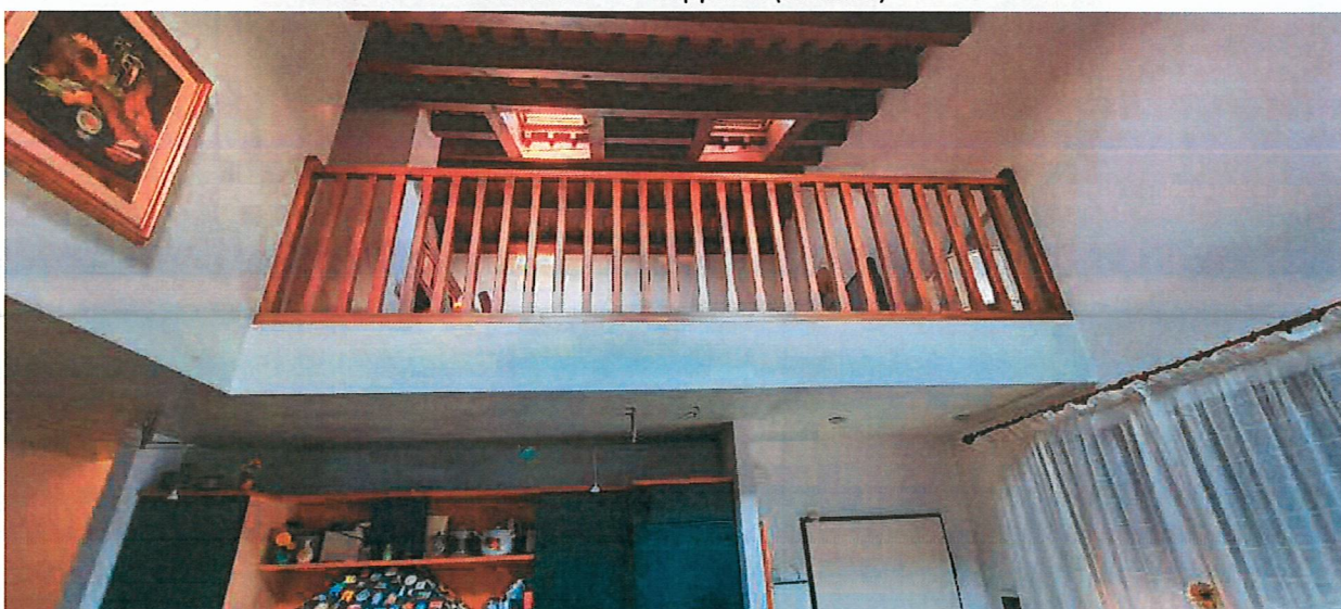
Sottotetto – 3 Soppalco (abusivo)
