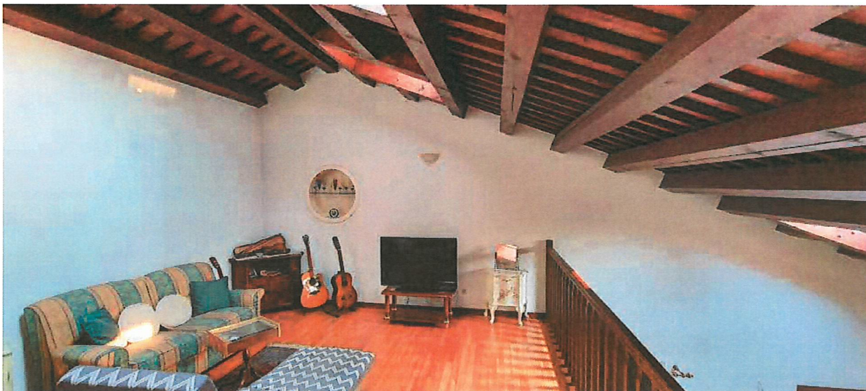
Sottotetto – 3 Soppalco (abusivo)
