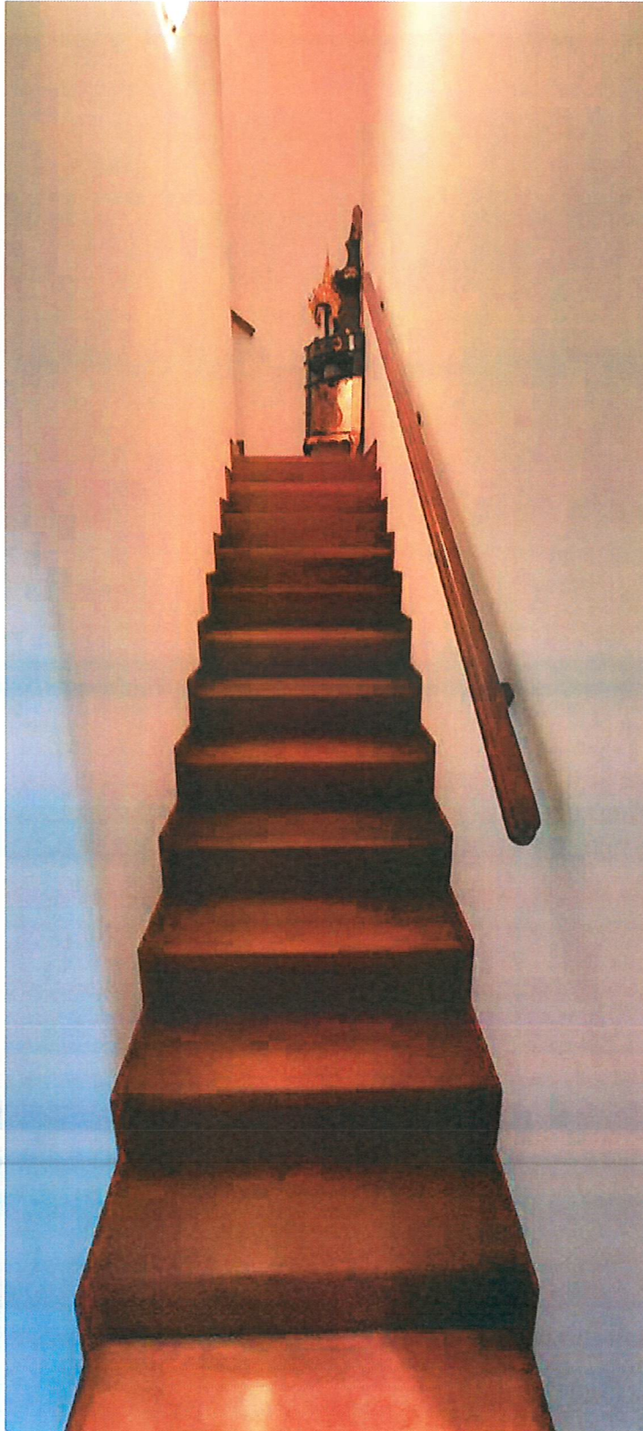
Scala di accesso al piano terzo Sottotetto (abusivo)
