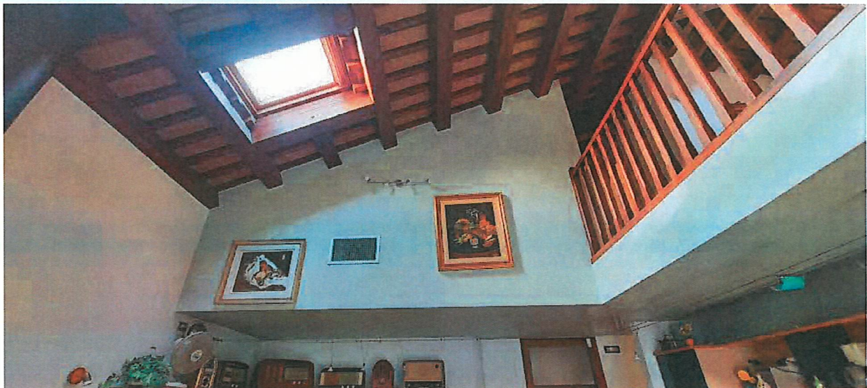
Vista del soppalco abusivo
