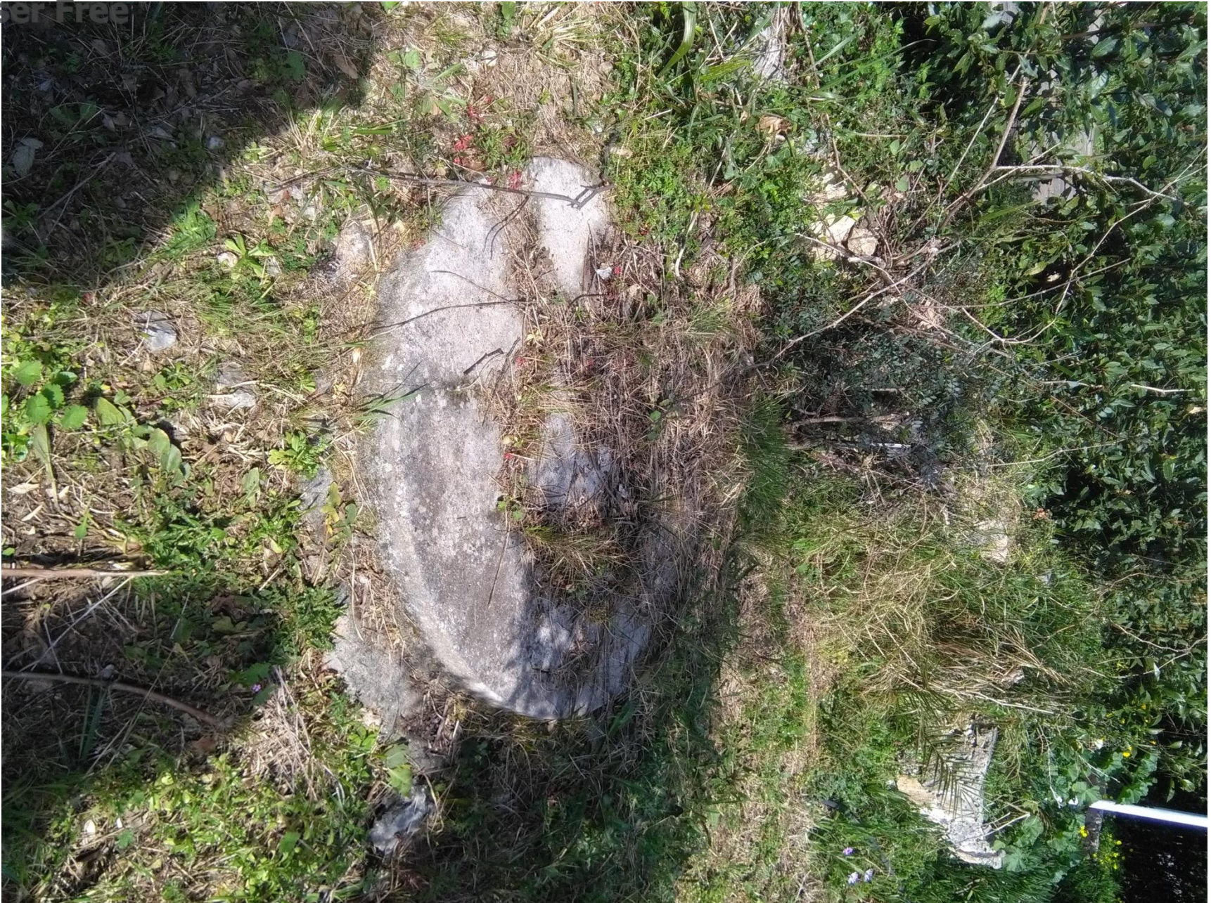
Punto di vista fotografico – 22 Fossa imhoff
