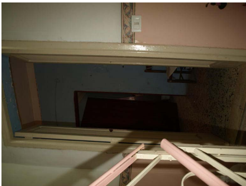
Foto n° 4 – Appartamento per civile abitazione sito in Gela con ingresso dalla via Francesco Petrarca n° 72, primo, secondo e terzo piano – Foglio 187 part. 454 sub 8 – Panoramica dell'ingresso al primo piano.
