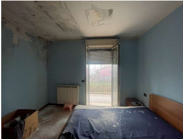
Camera da letto (soffitto con ammaloramenti degli intonaci)
