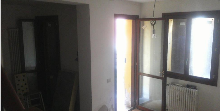
Figura 24: Vista appartamento Ingresso con ammaloramenti di intonaco e pittura
