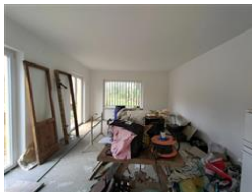
INTERNO – PIANO TERRA (fabbricato residenziale dist. cat. Fg. 16, mapp. 274) - vista del locale Soggiorno (NB: LAVORI SOSPESI E NON COMPLETATI)
