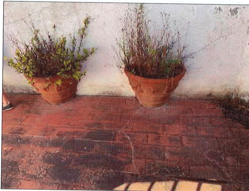
Dettaglio di alcune delle lesioni sul pavimento del terrazzo
