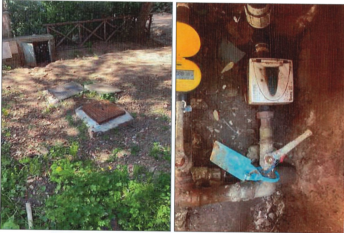
Dettaglio degli impianti
