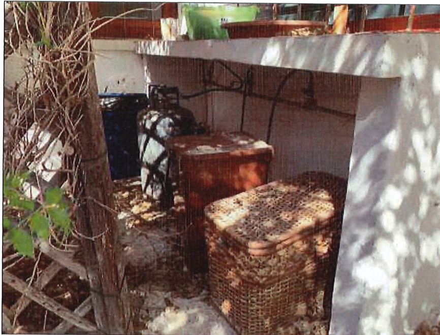
Dettaglio degli impianti
