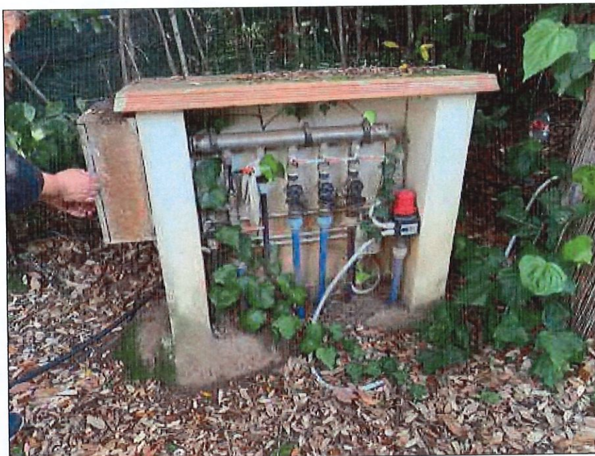
Dettaglio degli impianti
