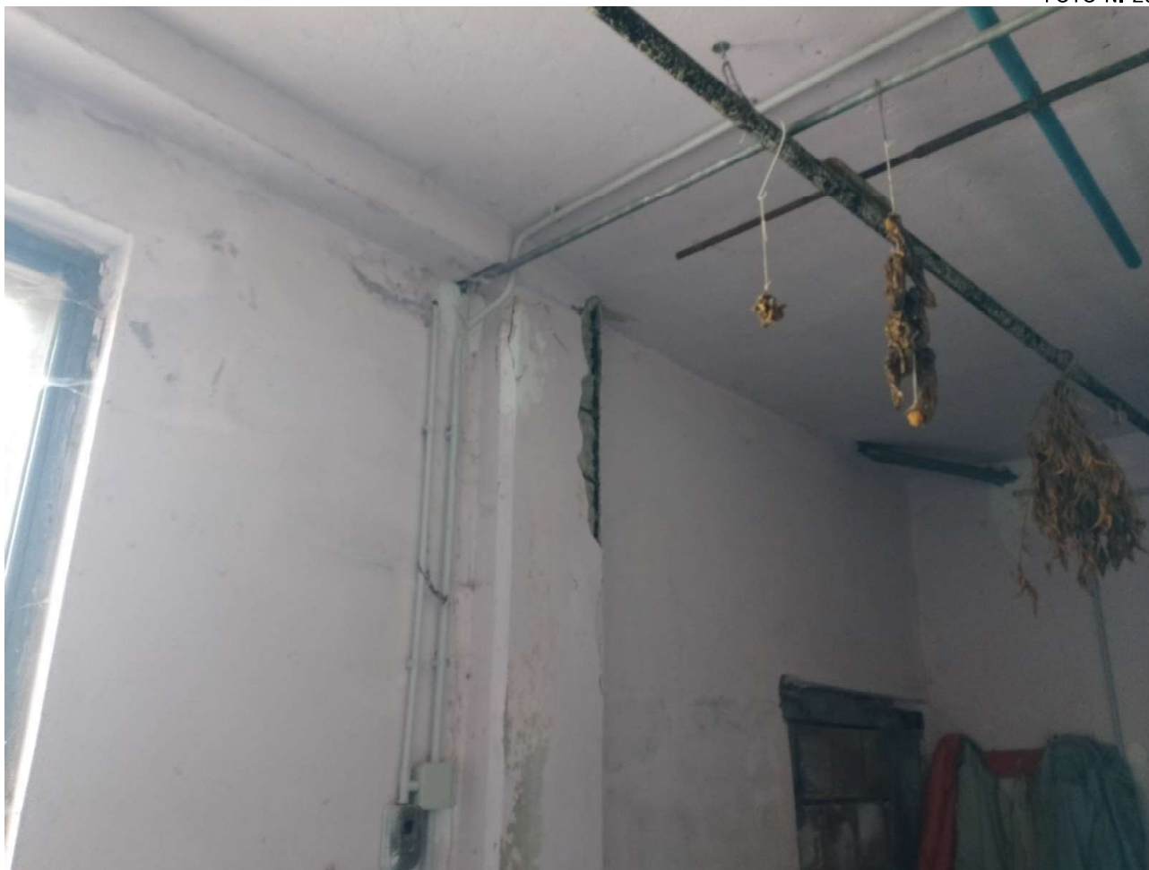
PARTICOLARE DEGRADO STATO DI CONSERVAZIONE
