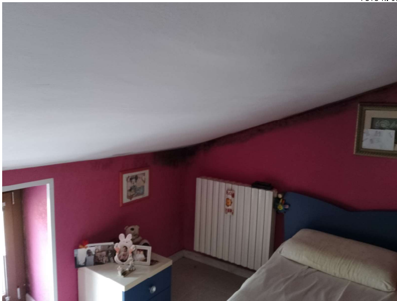
PARTICOLARE SEGNI DI CONDENSA
