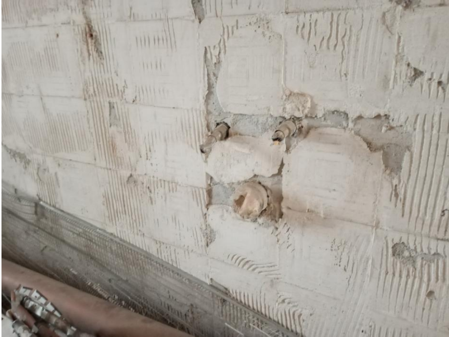
Foto 25_ particolare dello stato fatiscente degli impianti
