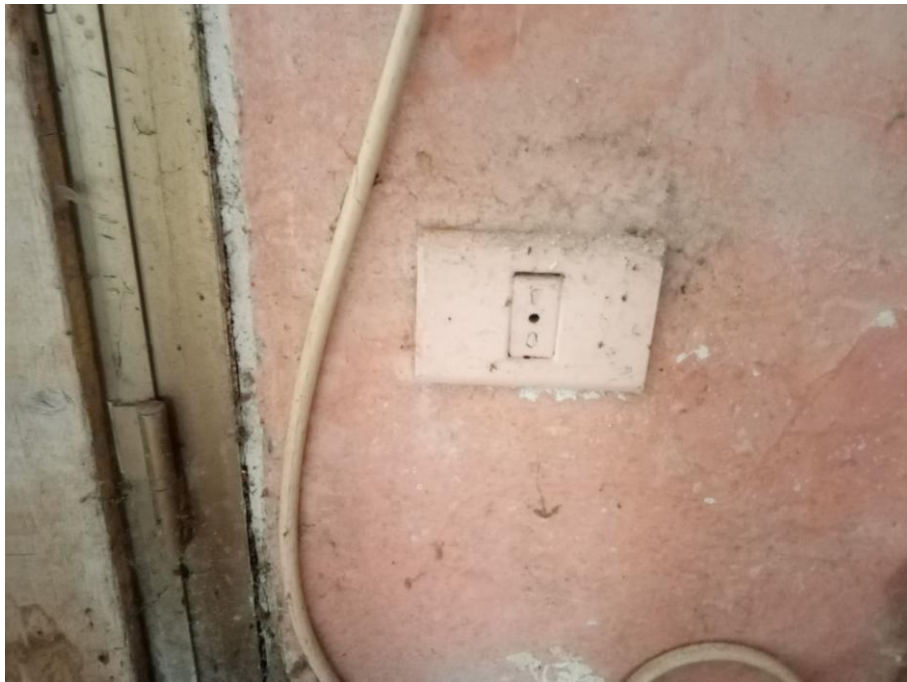
Foto 24_ particolare dello stato fatiscente degli impianti
