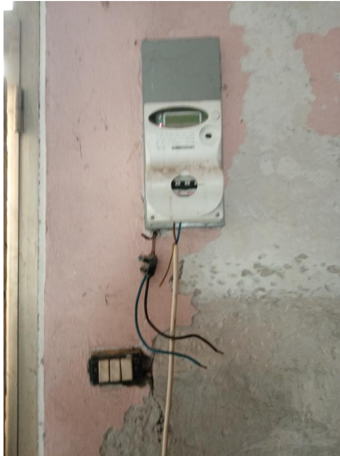
Foto 23_ particolare dello stato fatiscente degli impianti
