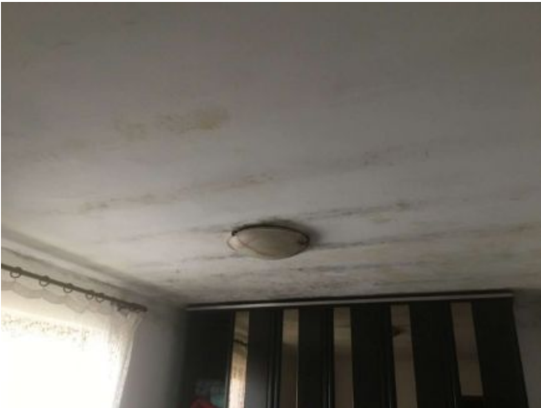
Camera al piano rialzato (altezza 2,58 m.) con evidenti tracce di condensa ed umidità..
