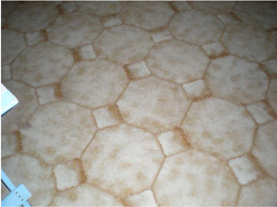
Foto 15: Pavimento camera piano primo
