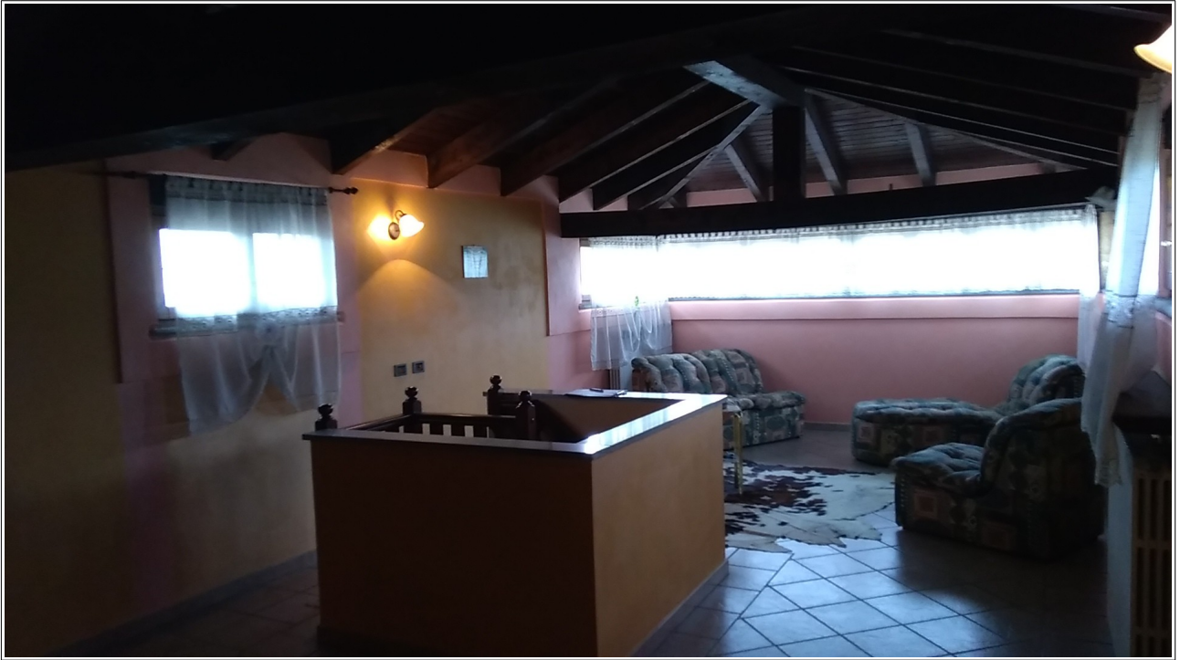
Interno sottotetto abusivo
