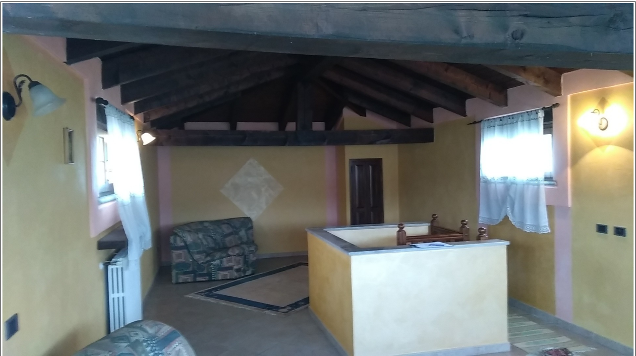
Interno sottotetto abusivo
