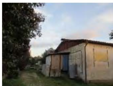
Foto n.°20 Particolare esterno box
