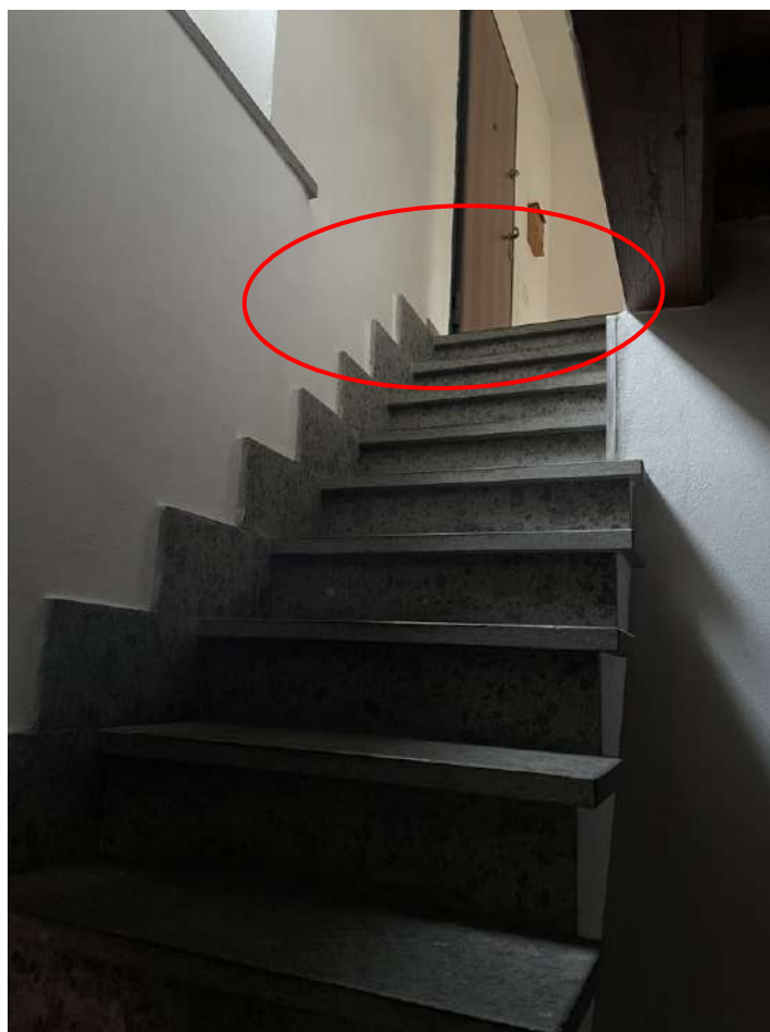
Dettaglio scala di collegamento interna con evidenza della criticità strutturale rilevata
