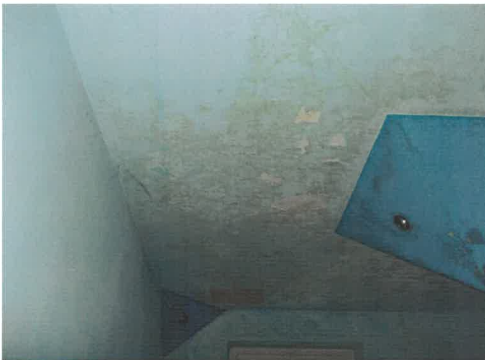
Foto 12 Particolare infiltrazione soletta cucina alloggio sub.7
