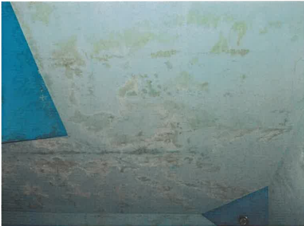
Foto 11 Particolare infiltrazione soletta cucina alloggio sub.7
