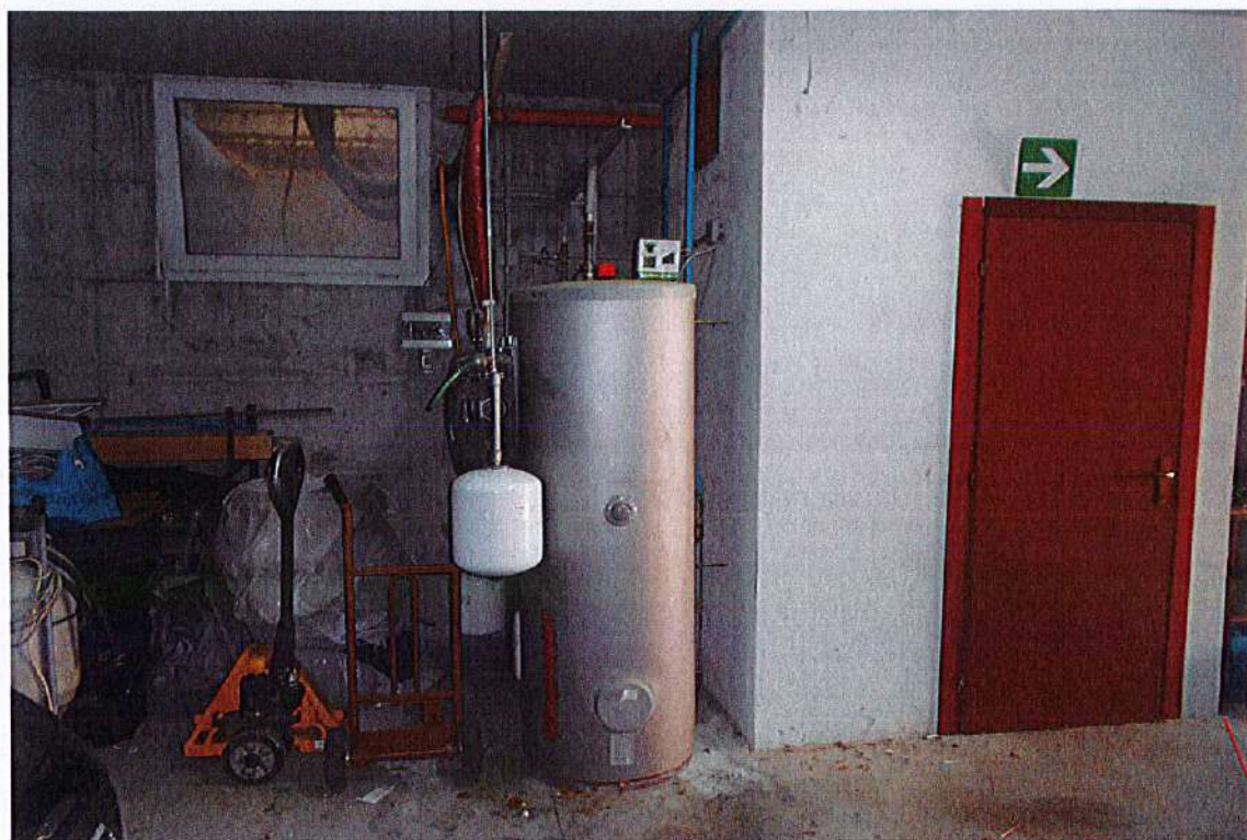
Particolare accumulo acqua impianto solare termico alloggiato sul locale sub. 7
