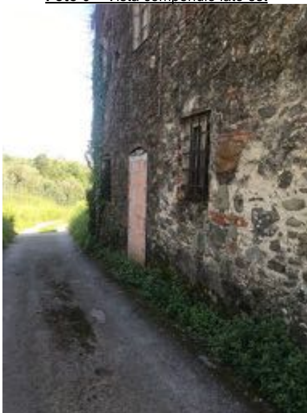
Foto 7 – Fronte lungo strada, porta murata per impedire accesso
