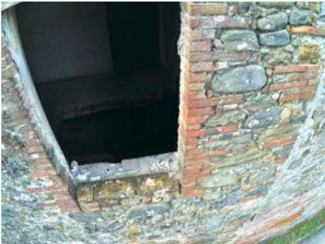
Foto 9 – Vista interni con solaio crollato
