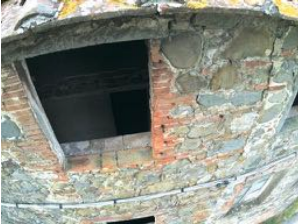
Foto 8 – Vista interni con solaio crollato
