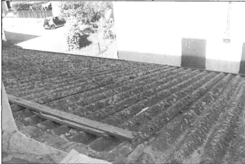
Copertura in Eternit
