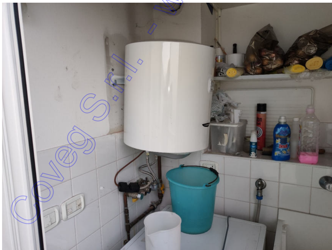
particolare boiler elettrico in sostituzione alla caldaia
