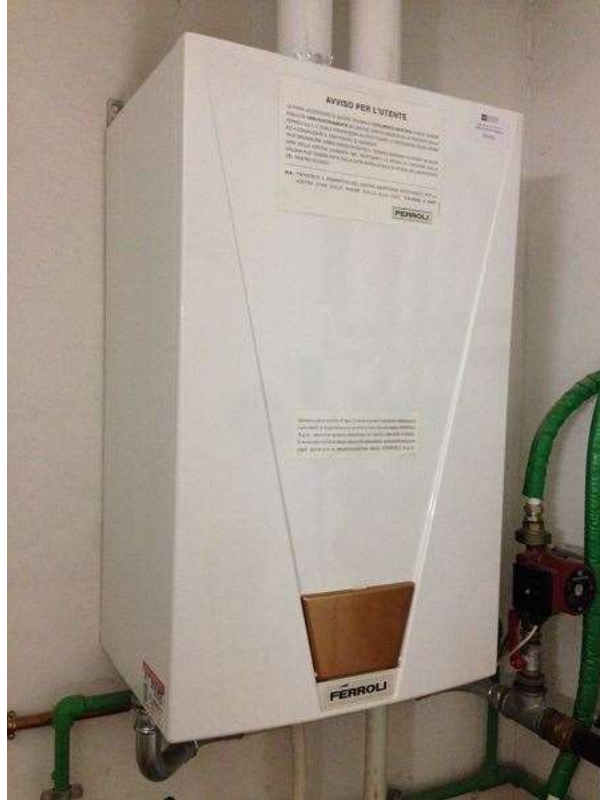
Foto n°47: LOCALE LAVANDERIA – C.T.
