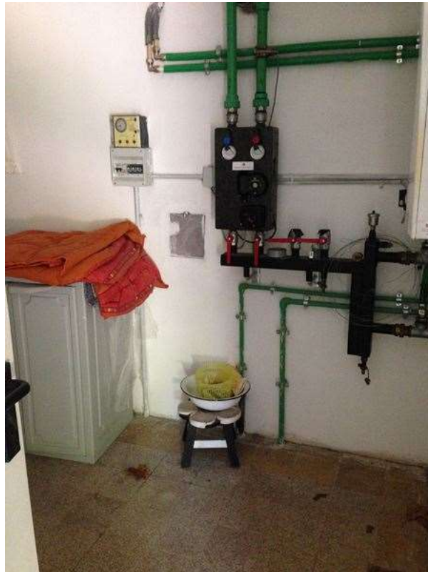
Foto n°31: LOCALE LAVANDERIA – C.T.
