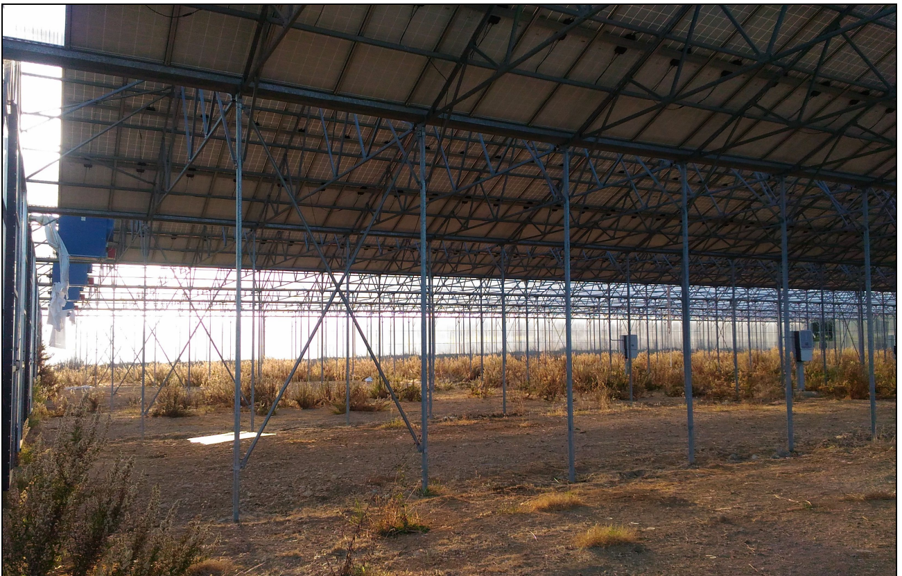
Vista interna – Serra multi tunnel con termogeneratori di aria calda
