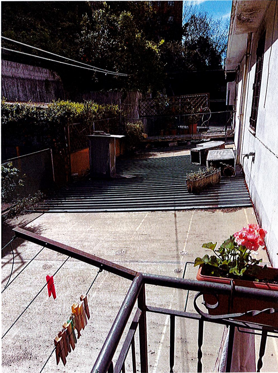
DISTACCO CON COPERTURA DEL LOCALE AL PIANO SOTTOSTANTE
