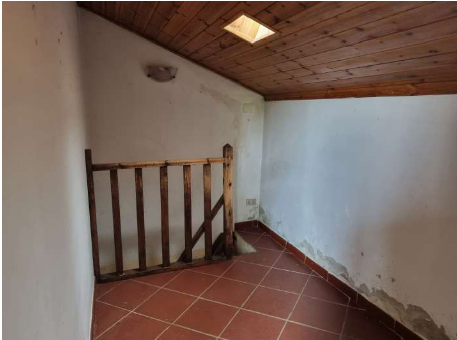
Ripostiglio con scala a scendere al disimpegno piano primo sono visibili nella muratura segni di infiltrazione provenienti dal terreno retrostante la muratura sanabili solo con opere di impermeabilizzazione e drenaggio
