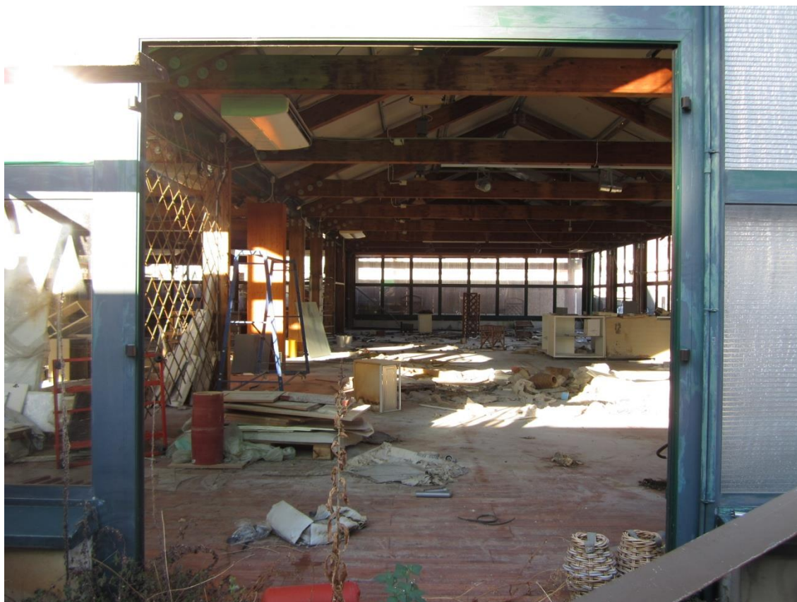
Foto 93: l'ingresso al prefabbricato centrale dei tre destinati alla "esposizione", indicati con il n. 1 nella planimetria catastale
