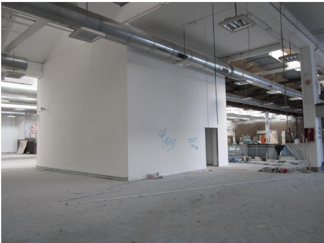
Foto 16: il blocco scale che collega verticalmente il piano terra al sottostante piano cantinato
