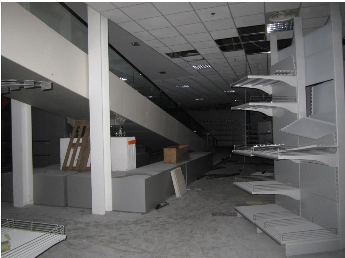
Foto 44: altra panoramica del piano cantinato, in corrispondenza dello sbarco del tappeto mobile di collegamento al soprastante piano terra
