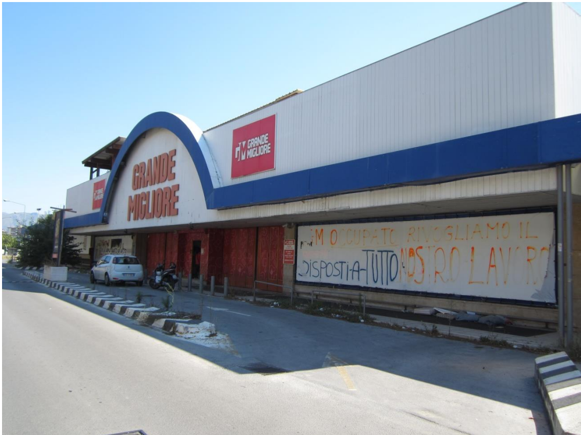
Foto 5: inquadratura del civico 4452 del Viale Regione Siciliana, da cui accede all'immobile denominato "Grande Migliore", individuato catastalmente, nel foglio 39 di Palermo, dalla particella 1015 sub. 5
