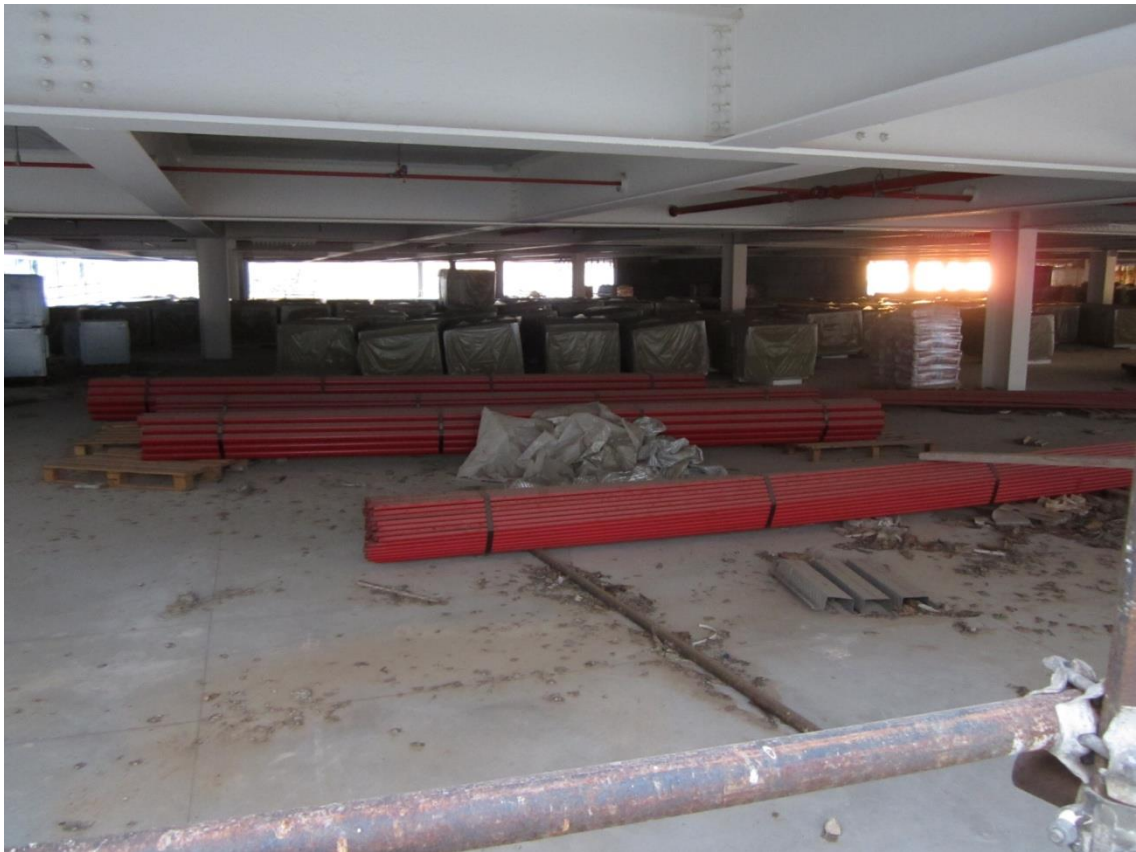
Foto 107: altra inquadratura del primo livello di sosta, sottostante il parcheggio a raso
