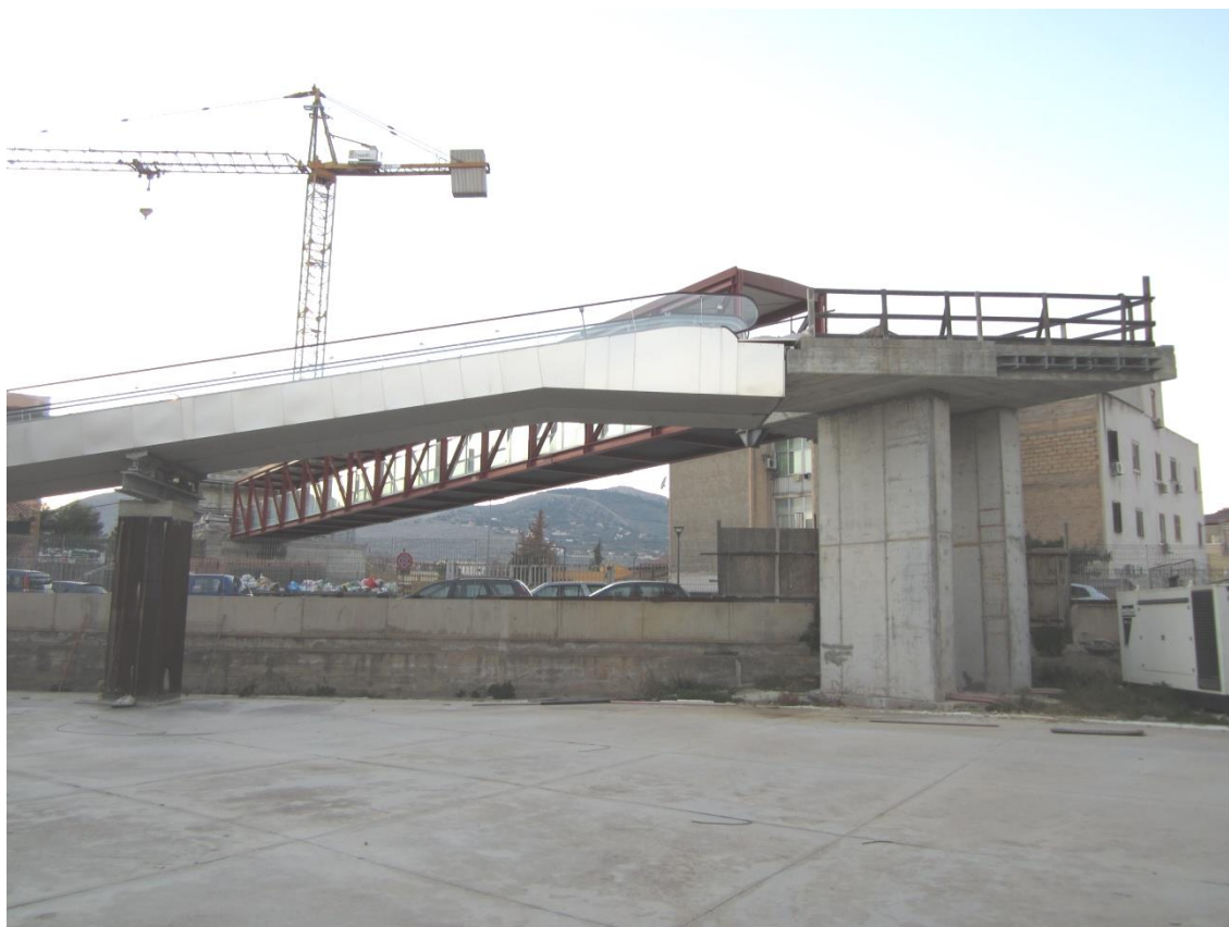
Foto 113: inquadratura, dal punto di vista opposto rispetto alla foto precedente, del nodo di atterraggio tra la pensilina proveniente dal parcheggio e il sistema di tappeti mobili che sbarcano alla quota del piano terra della struttura "Grande Migliore"
