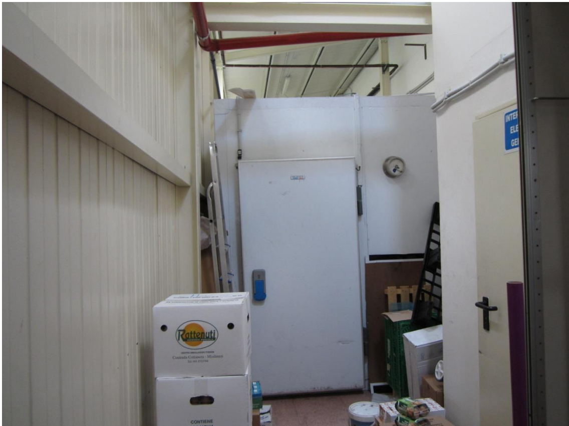
Foto 69: una delle celle frigorifere a servizio dell'immobile
