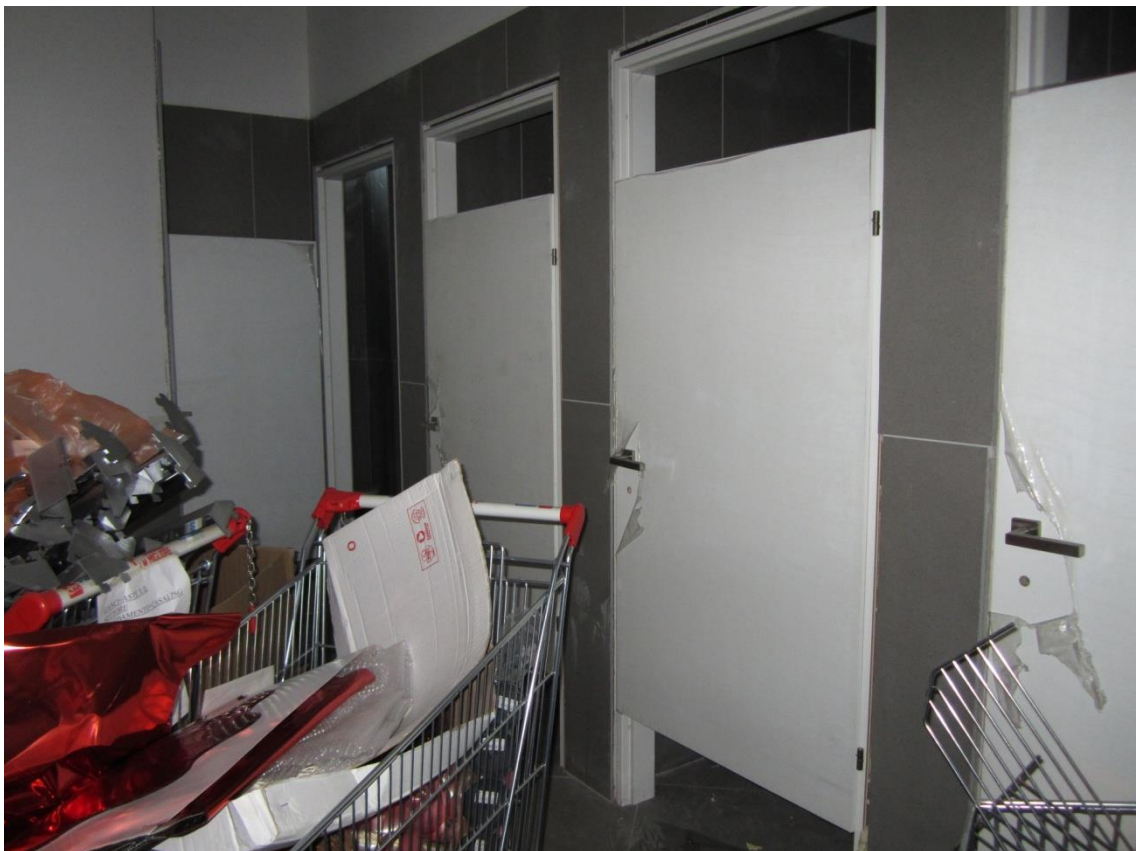
Foto 46: il blocco w.c. a servizio del piano cantinato
