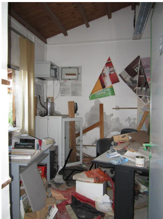
Foto 85: il locale ufficio ricavato nei manufatti in muratura, indicati nella planimetria catastale con i numeri 3 e 4
