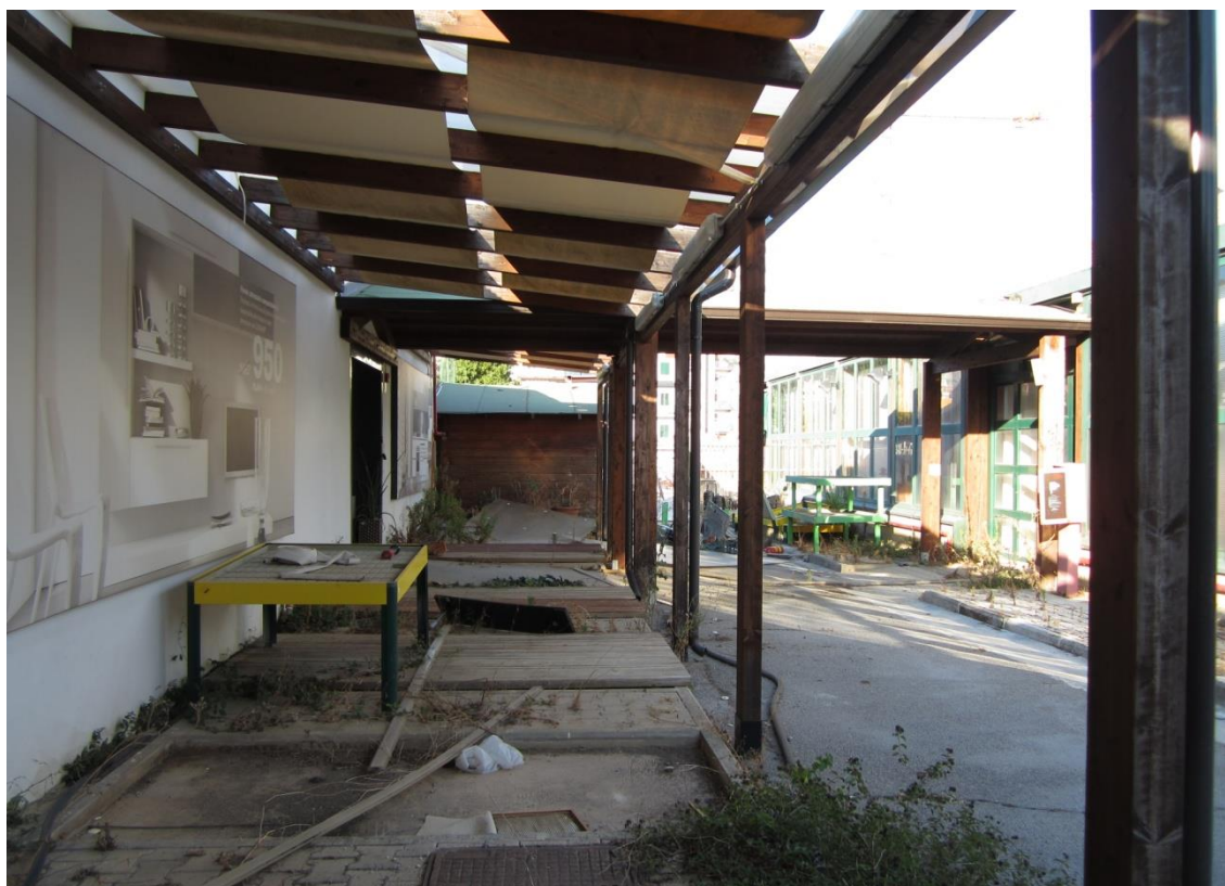
Foto 90: la "tettoia" lungo il confine nord, indicata con il n. 5 nella planimetria catastale; in fondo il box in legno, indicato con il n. 2 nella planimetria catastale, nel quale erano allocati gli impianti idrici; sulla destra una tettoia non rappresentata né catastalmente né nei grafici della concessione in sanatoria
