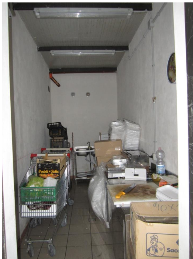
Foto 66: il "locale tecnico", limitrofo all'area destinata ad "attività commerciale", ubicata sul lato ovest dell'immobile
