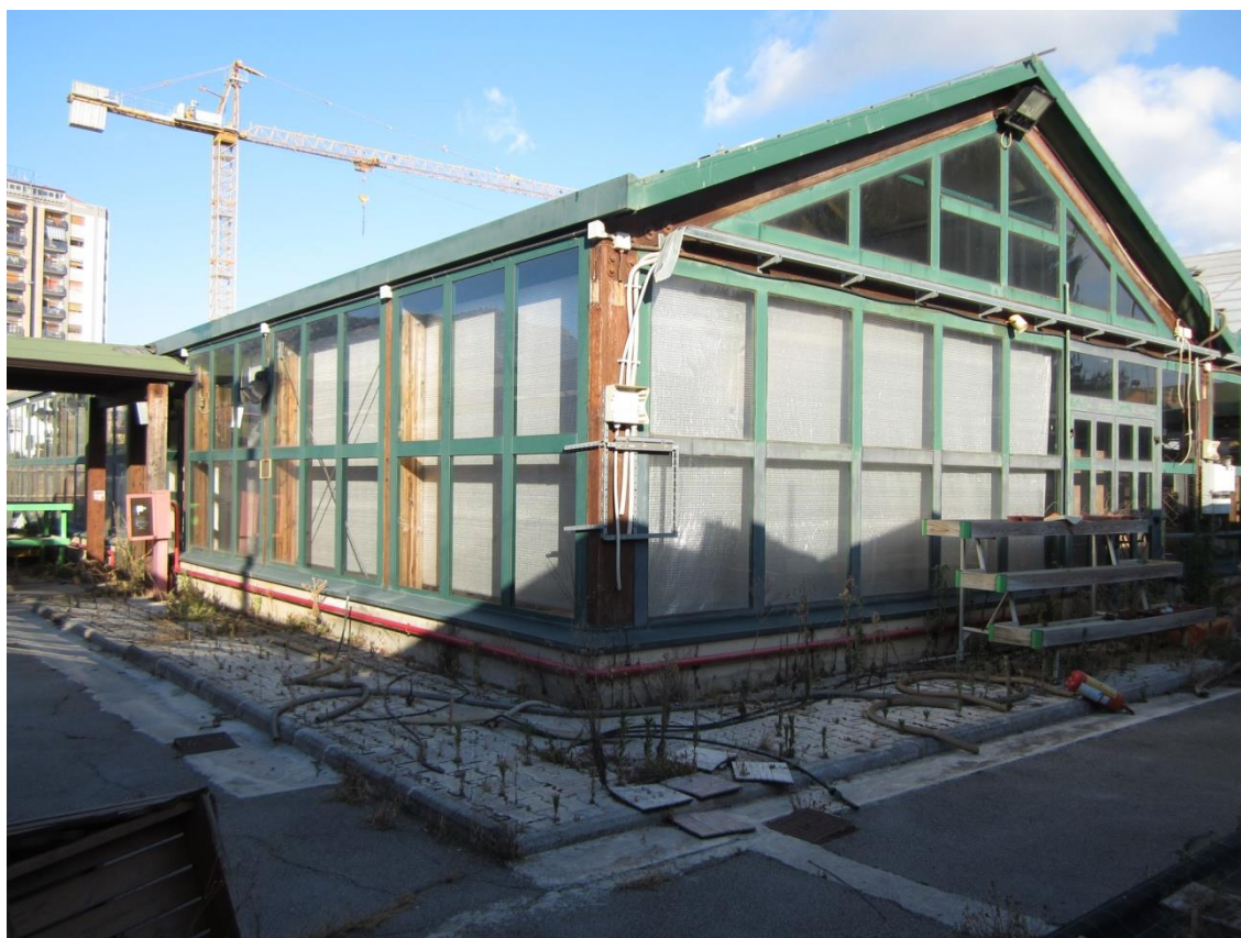
Foto 92: uno dei tre prefabbricati destinati alla "esposizione", indicati con il n. 1 nella planimetria catastale
