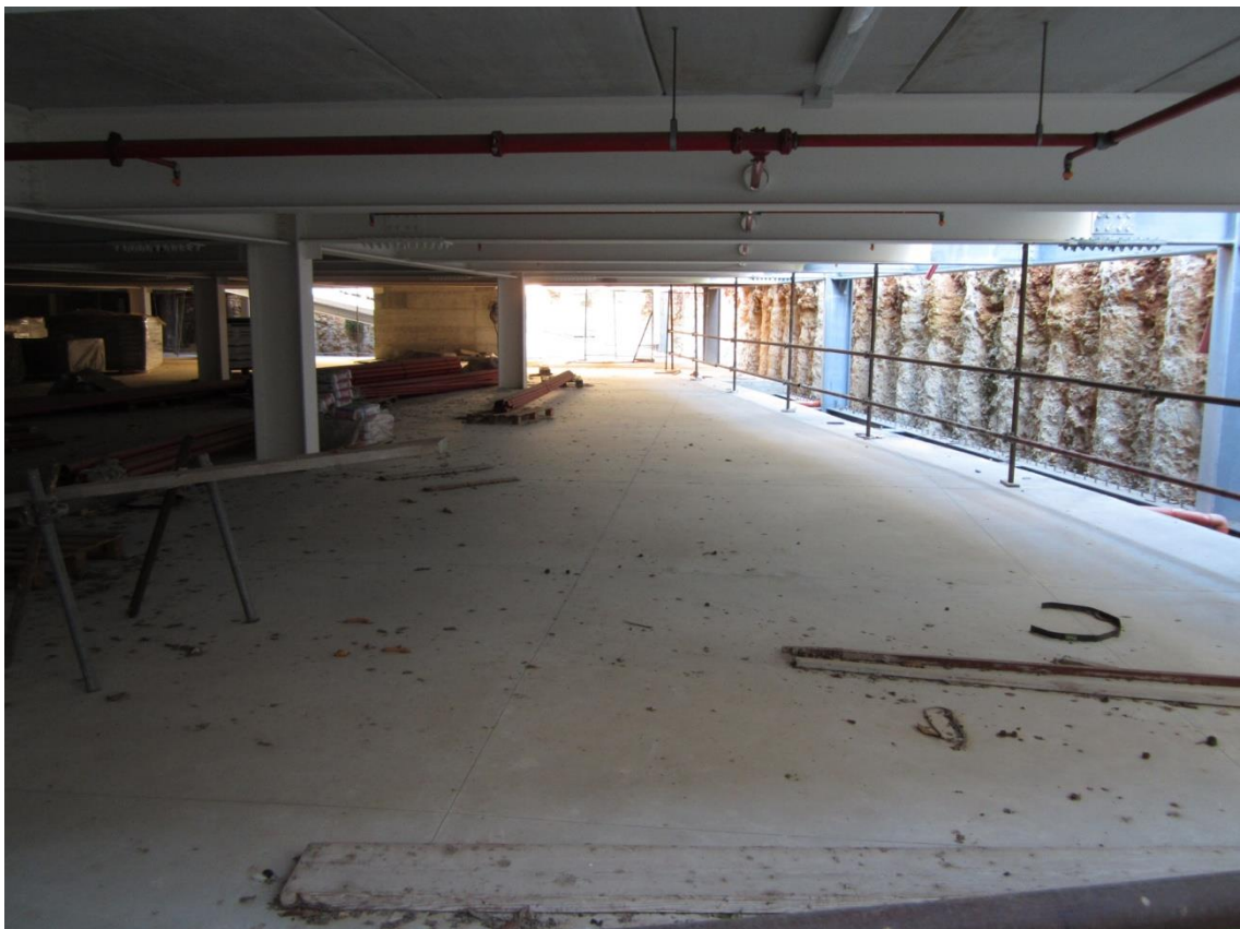
Foto 108: altra inquadratura del primo livello di sosta, sottostante il parcheggio a raso
