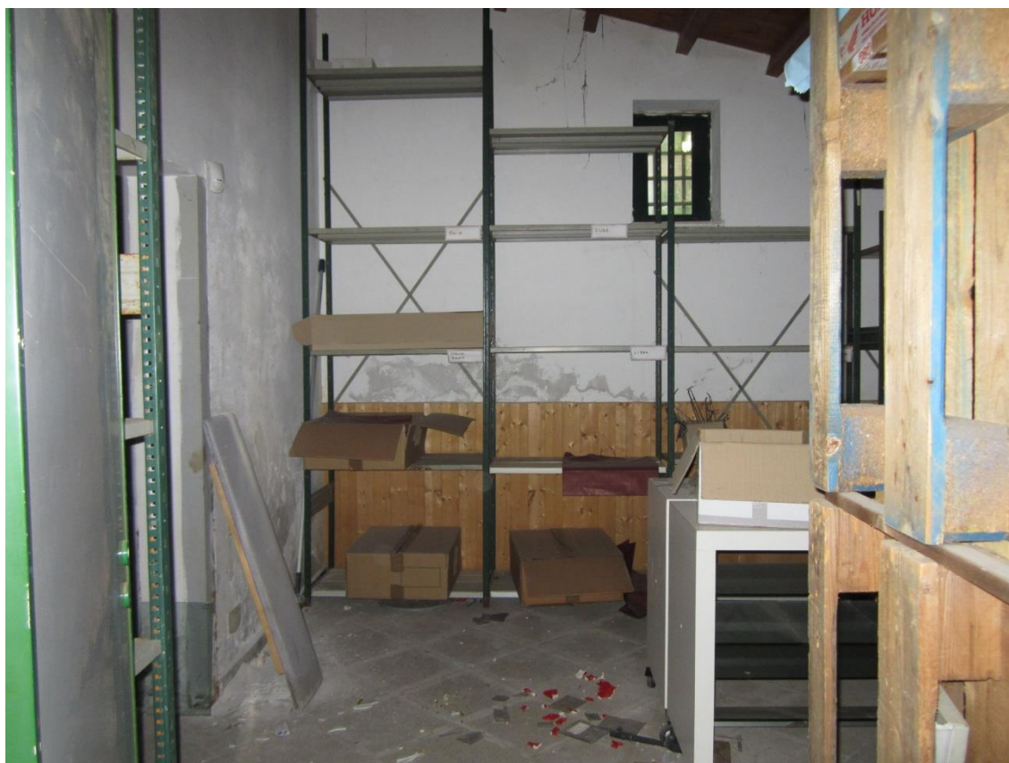
Foto 86: il magazzino ricavato nei manufatti in muratura, indicati nella planimetria catastale con i numeri 3 e 4
