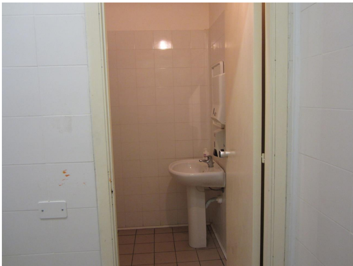
Foto 58: uno dei w.c. a servizio del piano terra
