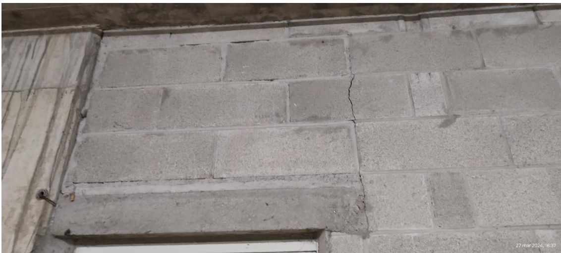
Sopra: Fessurazioni al piano interrato
