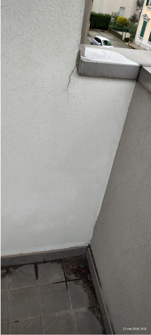
Sopra: fessurazioni sui balconi, immagine esemplificativa
