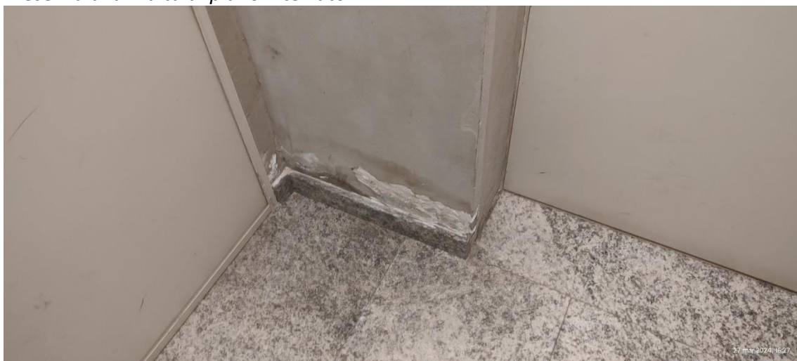
Presenza di umidità al piano interrato
