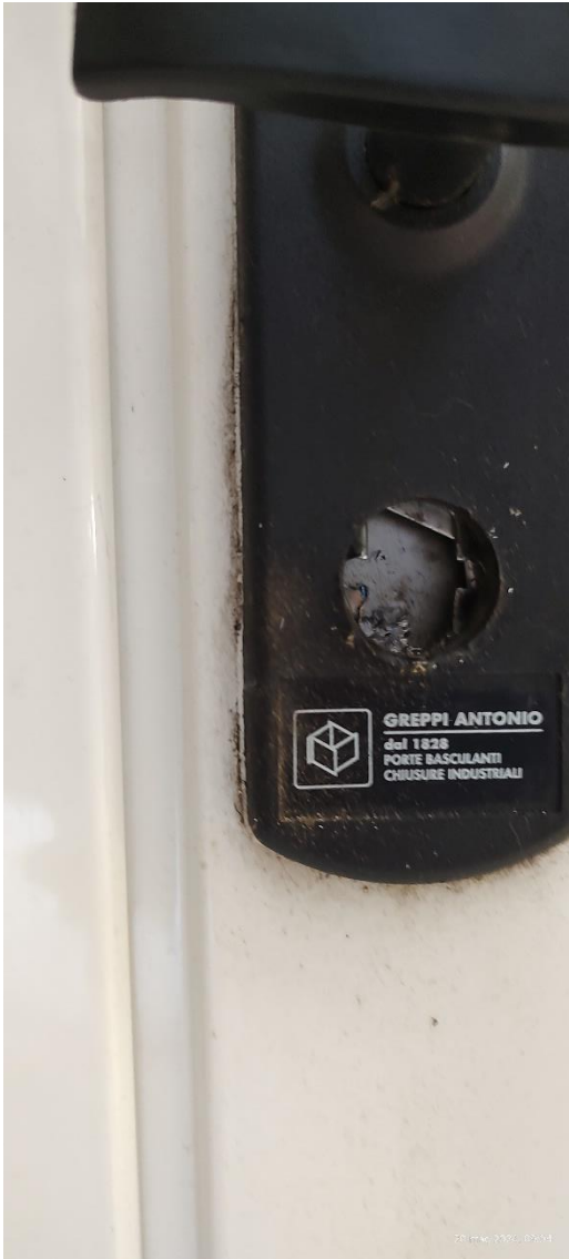
Veduta dei possibili problemi alle serrature dei box
