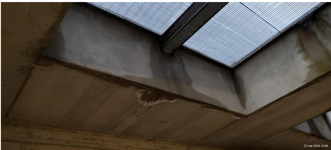
Sotto: Infiltrazioni e percolazioni nel corsello box
