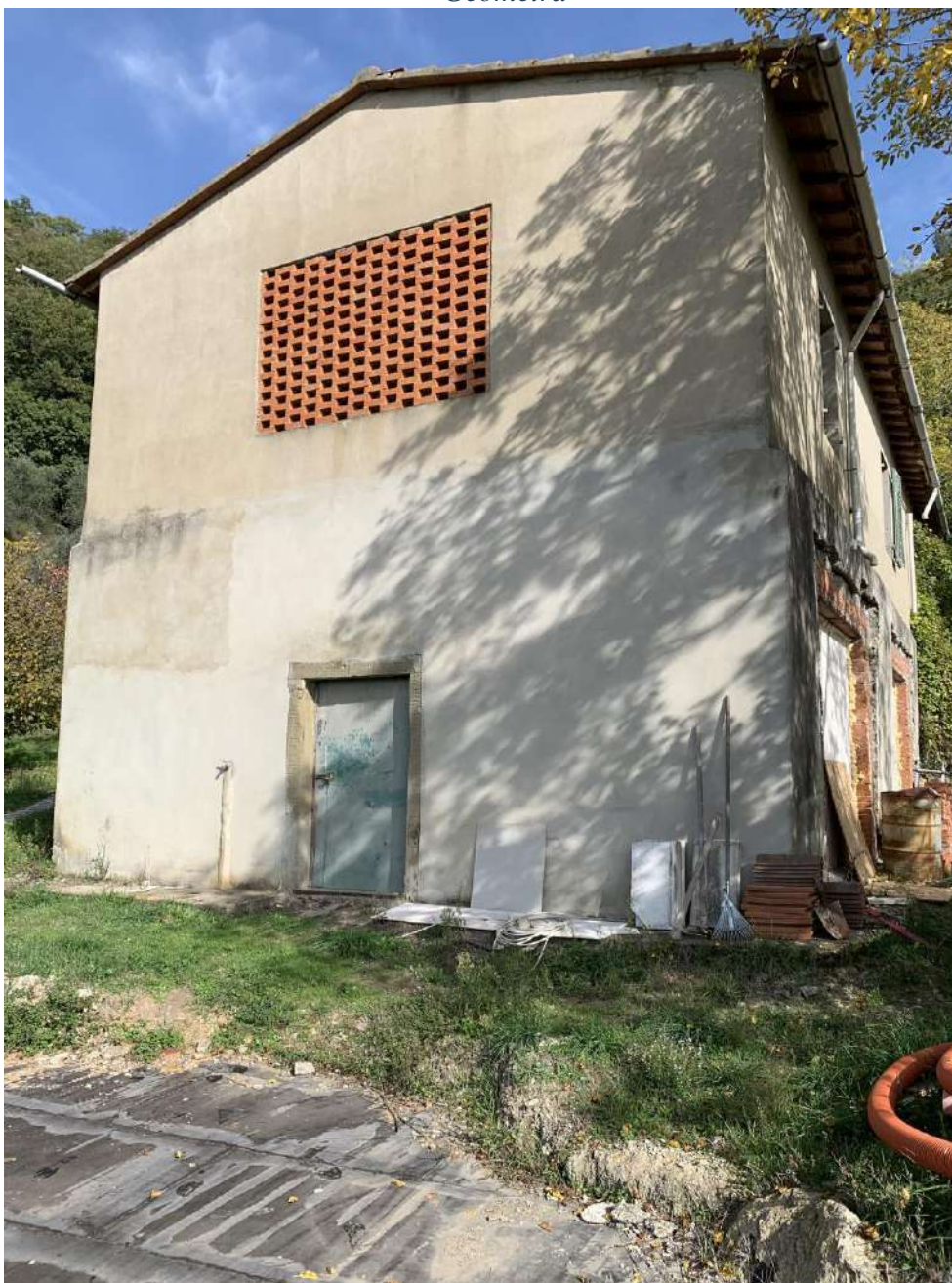
Foto n. 35 vista esterna del fabbricato “C”, con vista delle Ex finestre trasformate senza titolo abilitativo in porte ;
