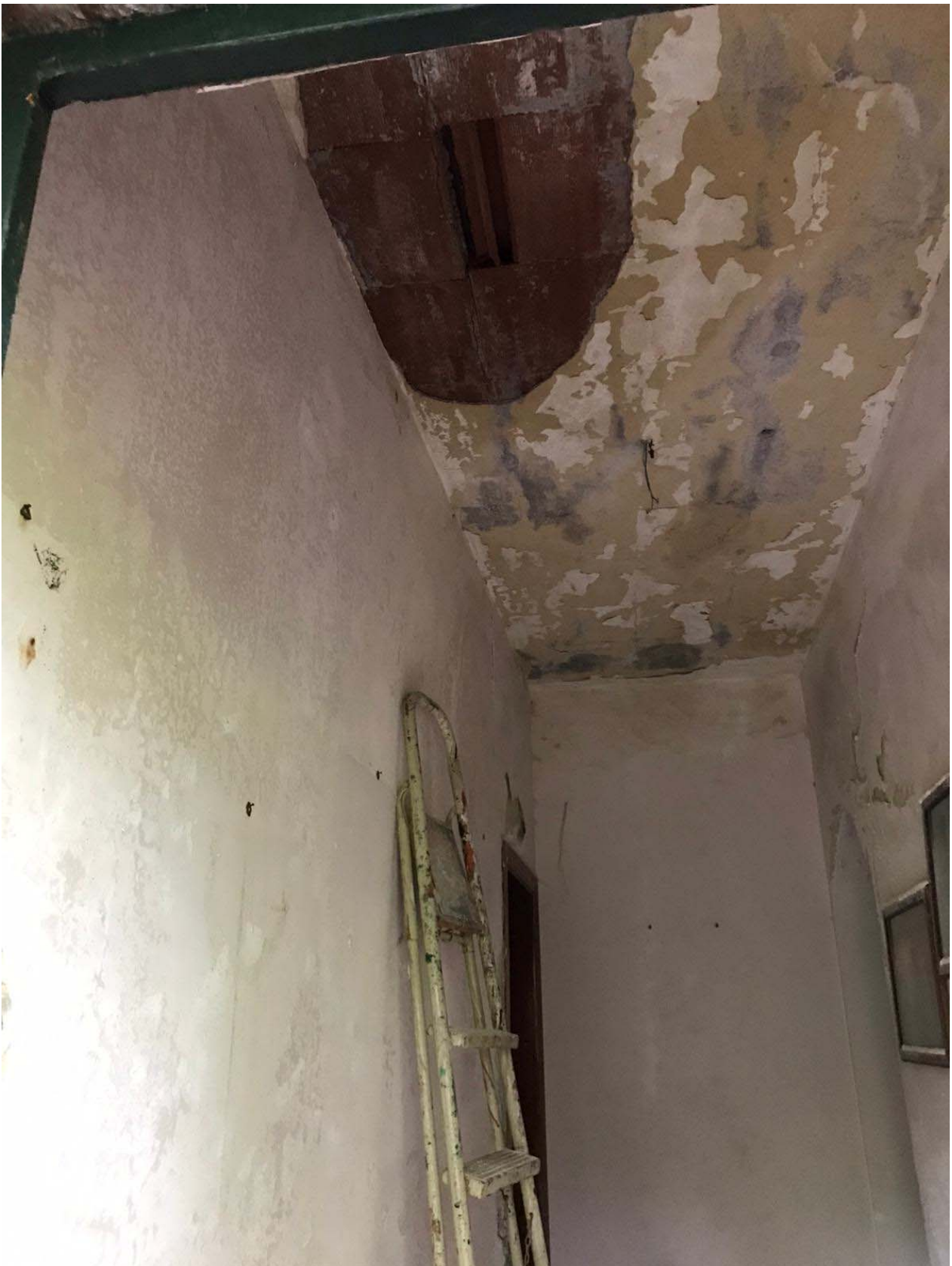
Foto n° 9 – foto del corridoio di ingresso con evidenti sfondellamenti delle pignatte del solaio e umidità proveniente dalla copertura non impermeabilizzata.
