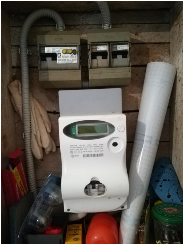
CUCINA - QUADRO ELETTRICO
