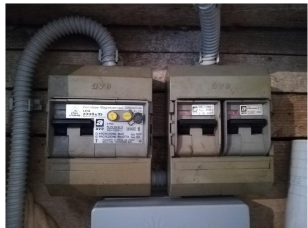
INTERRUTTORE MAGNETOTERMICO INTERRUTTORI GENERALI
