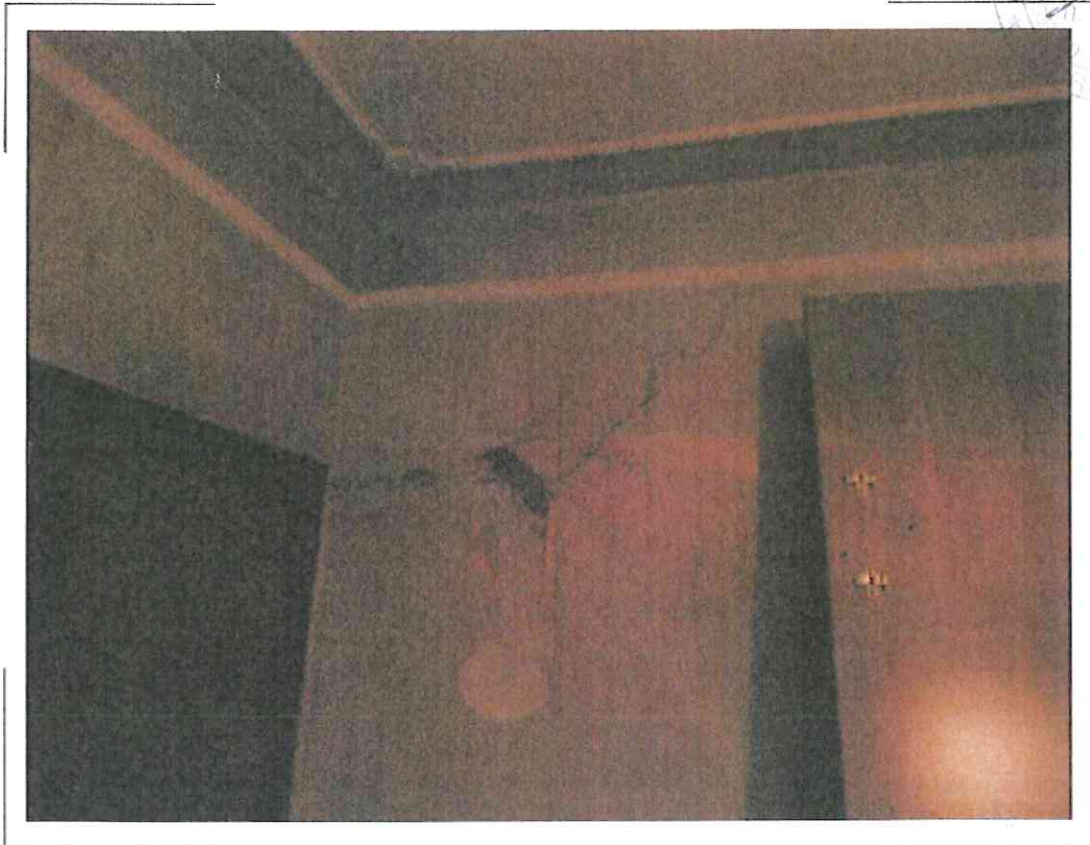
37) Particolare delle lesioni sul tramezzo che divide le due camere posta ad est della porzione di abitazione al piano primo
