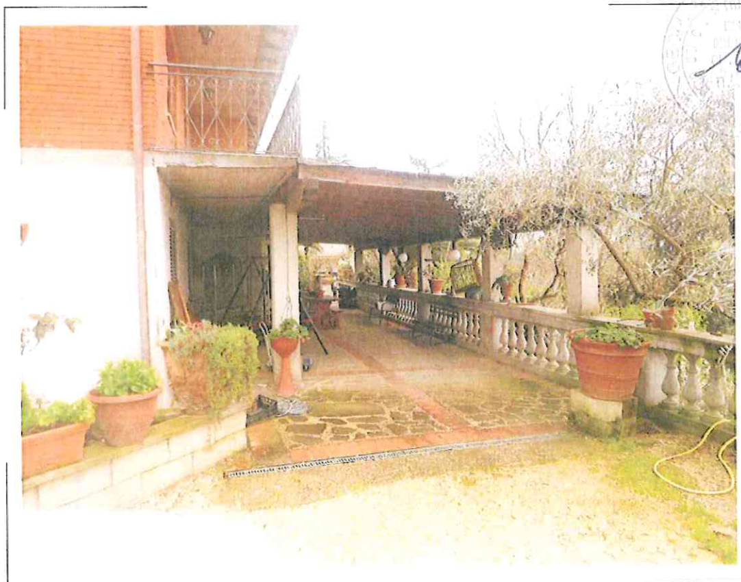
77) Particolare del portico in c.a. a servizio dei beni oggetto di stima censita al NCEU al Fg.198 p.IIa 143 sub. 1 e 2
