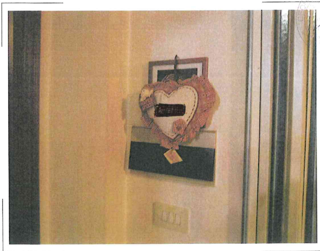
69) Particolare dell'ubicazione del quadro elettrico a servizio dei locali al piano terra
