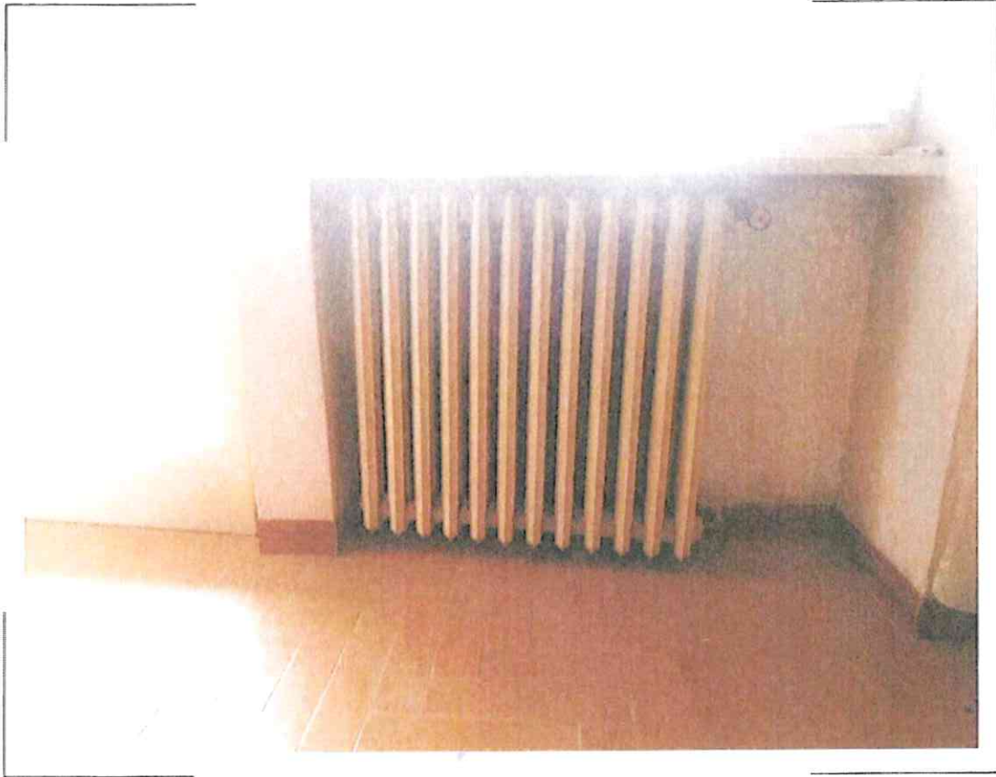
33) Particolare degli elementi radianti a servizio della porzione di abitazione al piano primo
