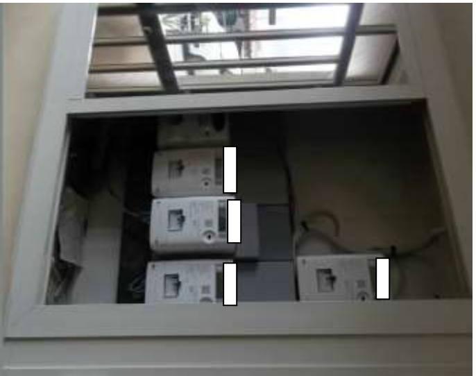
Foto 16 – contatore Energia Elettrica
